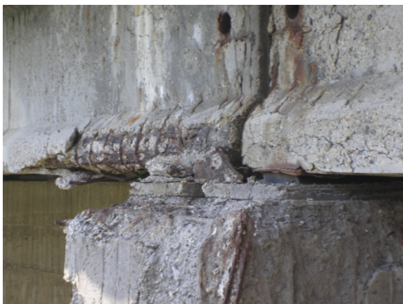
Abb. 83: Stützbereich: Risse, Abplatzungen
