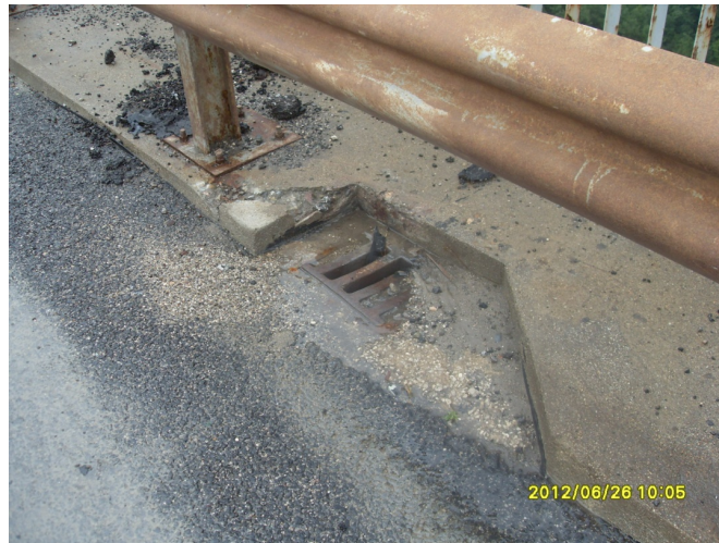
Abb. 31: Brücke Bebresch auf der Autobahn Hemus: verstopfte Entwässerungseinrichtung 55
