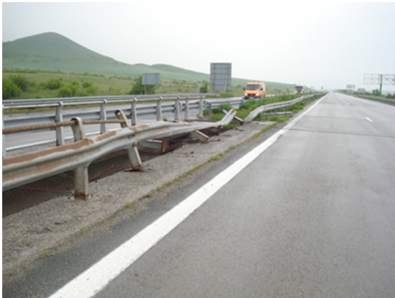
Abb. 34: Anprallschäden an Leitschienen 59
