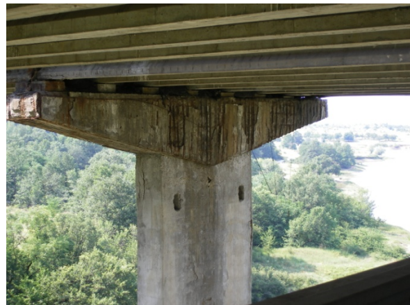
Abb. 82: Pfeilerkopf in kritischem Zustand
