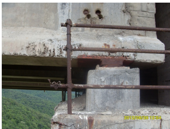
Abb. 59: Hauptträger: Risse, Abplatzungen
