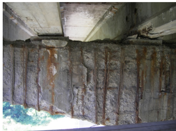
Abb. 84: Pfeilerköpfe: Abplatzungen, Korrosion
