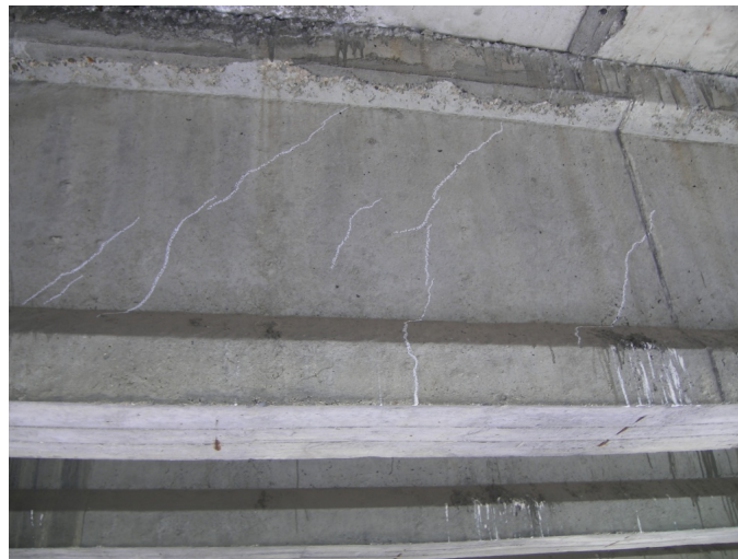
Abb. 38: Brücke Autobahn Trakija (km 67): schräge Risse im Stützbereich 66
