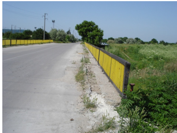
Abb. 33: Schäden am Randbalken 58
