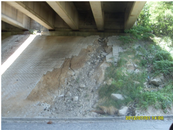
Abb. 73: Böschungskiel: zerstörte Abdeckung
