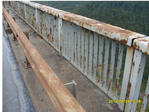
Abb. 35: Brücke Bebresch: Korrosion des Geländers 60
