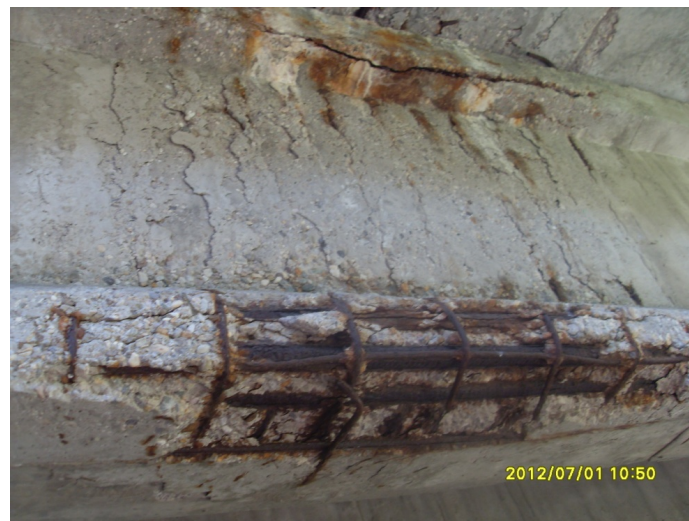
Abb. 39: Brücke Autobahn Trakija (km. 67): Korrosion der Bewehrung 72
