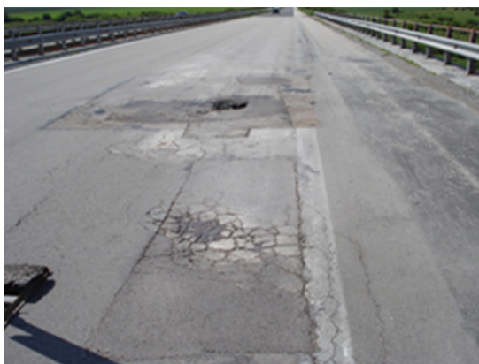
Abb. 24: Brücke auf Autobahn Hemus 380+680 – Schäden an der Asphaltdecke 48
