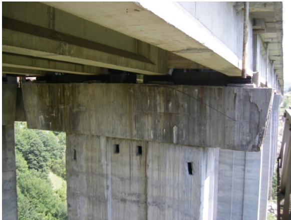
Abb. 71: Riegel: Spuren von Wasserdurchtritt
