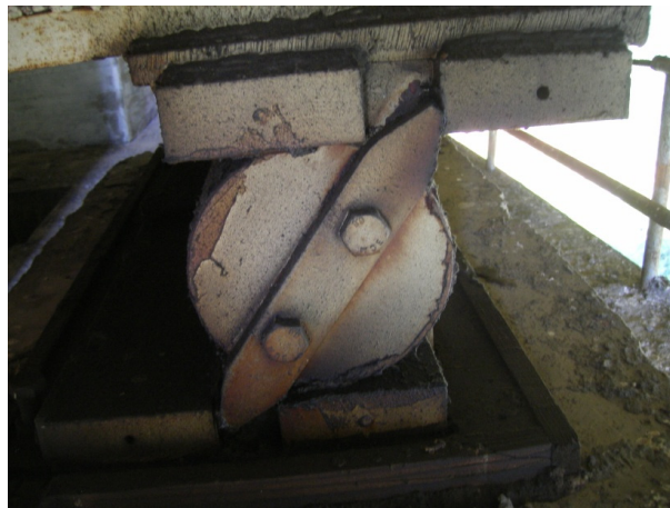
Abb. 42: Brücke Bebresch: Korrosion und Ausschöpfung des Bewegungsvermögens bei einem Rollenlager 77
