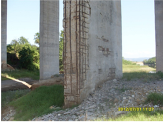
Abb. 40: Brücke Autobahn Trakija (km. 67): Betonabplatzungen und Korrosion der Bewehrung bei Brückenstützen 74
