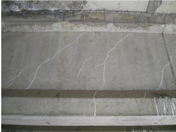
Abb. 79: Hauptträger: schräge Risse
