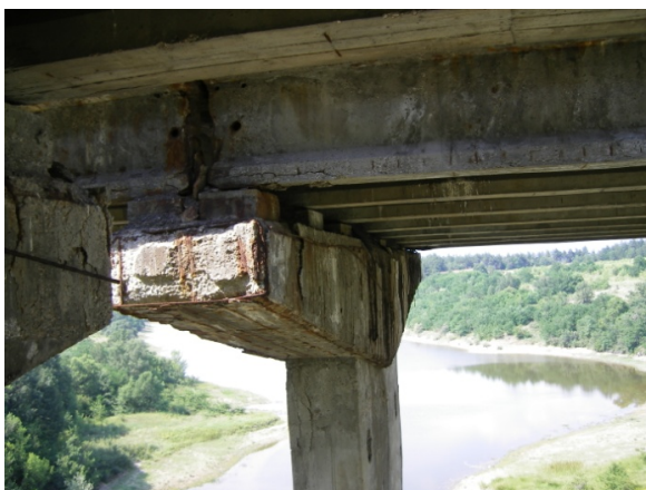
Abb. 77: Hauptträger, Stützenkopf: Abplatzungen
