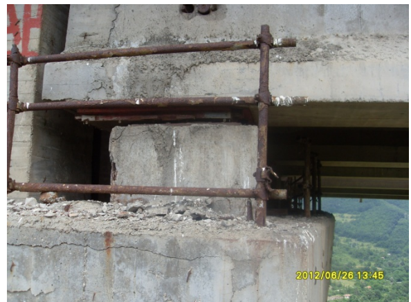
Abb. 66: Lager und Lagersocket: Risse
