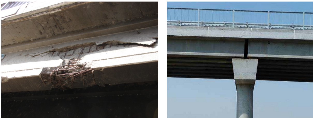
Abb. 20: Hauptträger: Links - sehr schlechter Zustand (1), Rechts - sehr guter Zustand (5) 37
