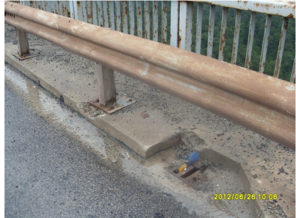
Abb. 62: Funktionale Elemente: Korrosion
