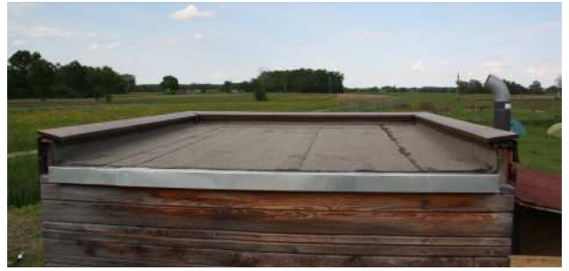
3.334 das Dach zwei Jahre danach
