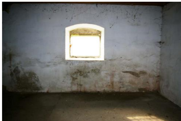
Abb. 63 Verfärbter Betonboden (K-05)
