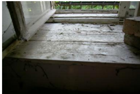
Abb. 130 Abgeblätterte Fensterbank (H-07)
