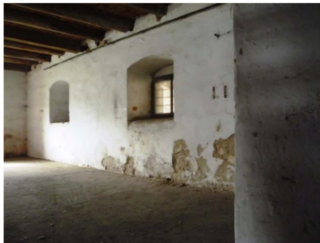
Abb. 71 Starke Abplatzung im Erdgeschoss, Hofseite (K-05)
