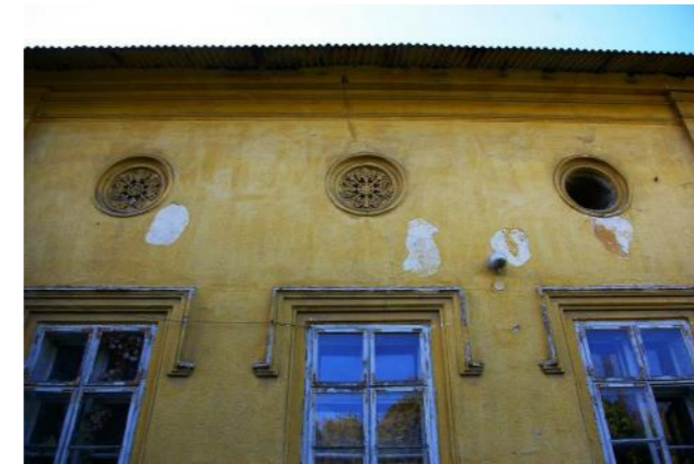
Abb. 229 Fehlende Rosette der nördlichen Fassade
