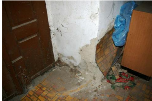
Abb. 65 Abgeplatzte Putzoberfläche (K-01)
