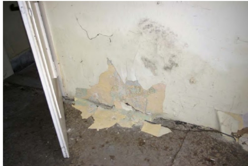
Abb. 241 Leicht abgeplatzte Putzoberfläche (S-07)
