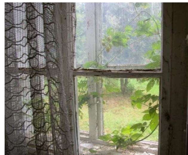
Abb. 238 Abgeblätterte Fensterflügel (S-02)
