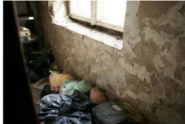
Abb. 141 Starke Abplatzung der Putzoberfläche (H-10)
