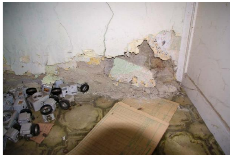
Abb. 242 Abgeplatzte Putzoberfläche des Sockelbereiches (S-06)
