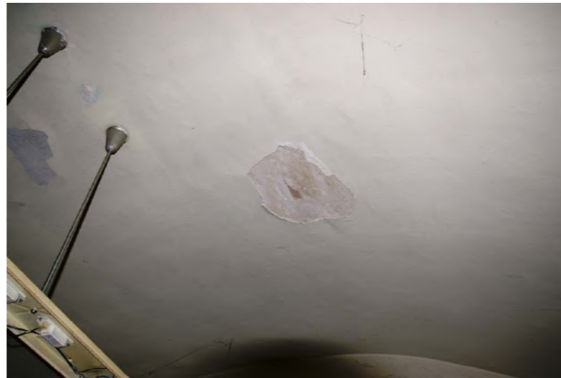
Abb. 240 Abgeplatzte Putzoberfläche an der Decke (S-05)
