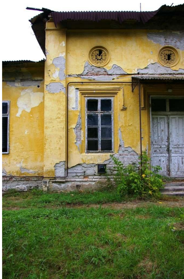
Abb. 226 Putzabplatzung an der südlichen Fassade
