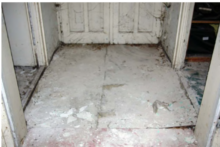
Abb. 237 Abgelöster Bodenbelag (S-01)
