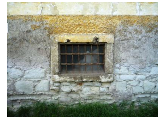
Abb. 53 Putzabplatzung der östlichen Fassade
