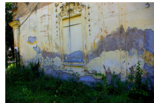
Abb. 125 Abplatzung an der nördlichen Fassade
