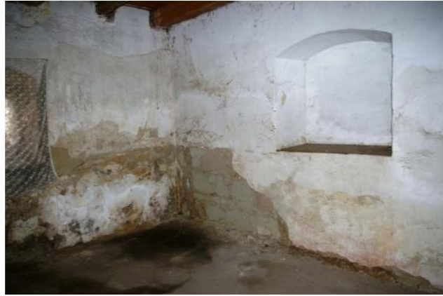
Abb. 69 Stark verfärbtes Eck im Erdgeschoss mit Putzabplatzung (K-05)
