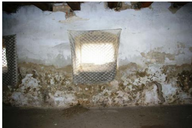
Abb. 70 Starke Abplatzung im Erdgeschoss, Straßenseite (K-05)
