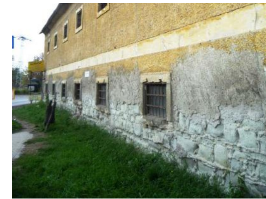
Abb. 52 Putzabplatzung der östlichen Fassade
