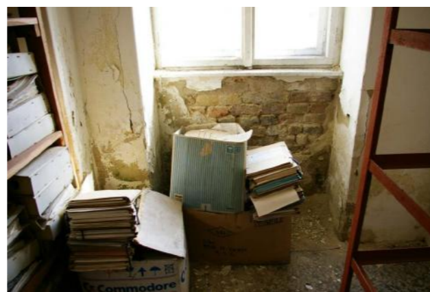
Abb. 143 Abplatzung des Putzgrundes (H-13)
