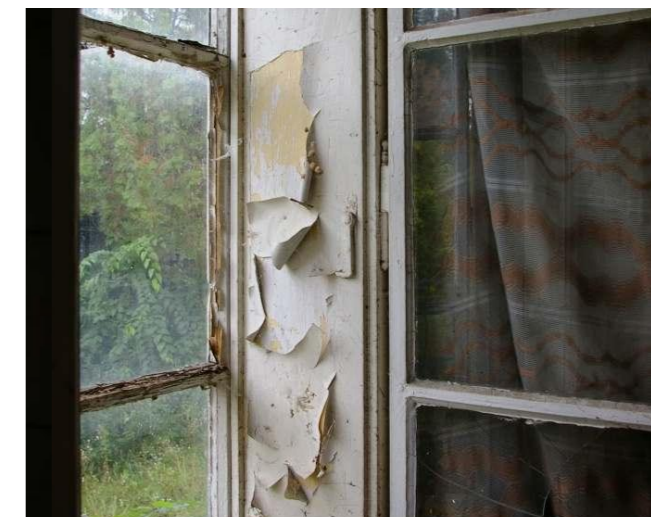
Abb. 239 Abgeblätterter Fensterrahmen (S-07)
