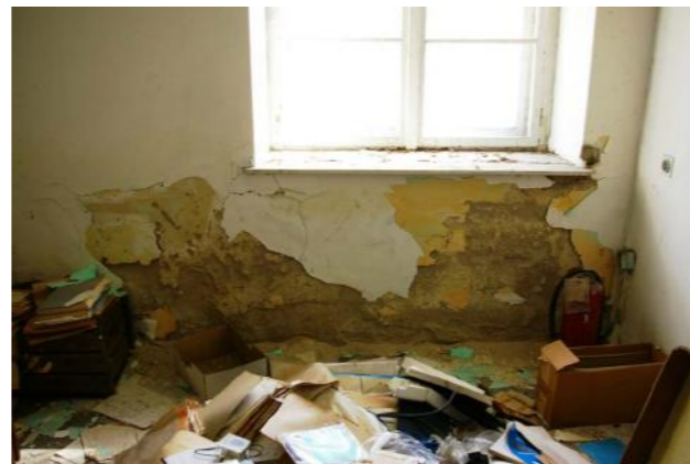
Abb. 142 Abplatzung des Putzgrundes (H-11)
