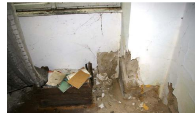
Abb. 137 Abplatzung der Putzoberfläche (H-13)
