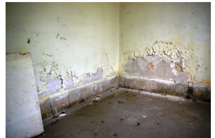
Abb. 245 Abgeplatzte Putzoberfläche mit verfärbte Wände (S-03)
