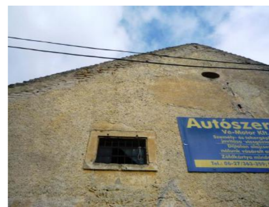
Abb. 51 Putzabplatzung der Giebelwandkante (Süd)
