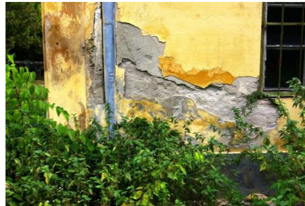
Abb. 122 Abplatzung der Putzoberfläche (West)
