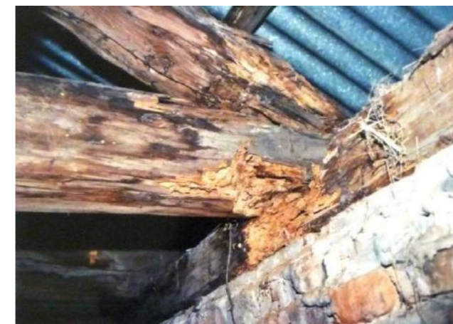
Abb.220 Verfaulte Holzelemente (Nordwest)
