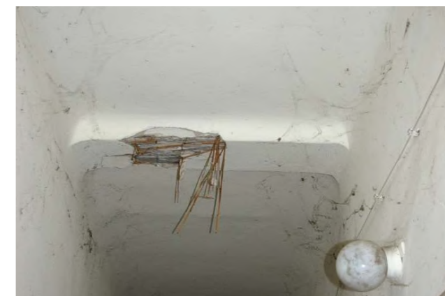
Abb. 138 Abplatzung der Putzoberfläche (H-13)
