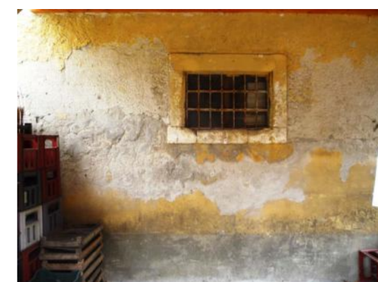
Abb. 54 Abgeplatzte Putzoberfläche (West)
