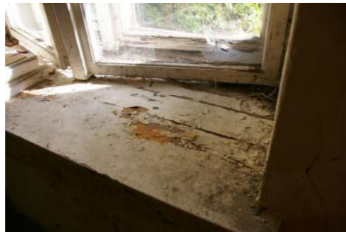
Abb. 131 Abgeblätterte Fensterbank (H-09)
