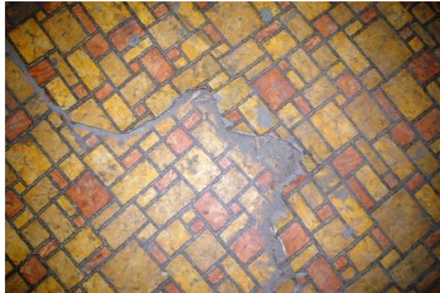
Abb. 62 Beschädigtes Linoleum (K-01)
