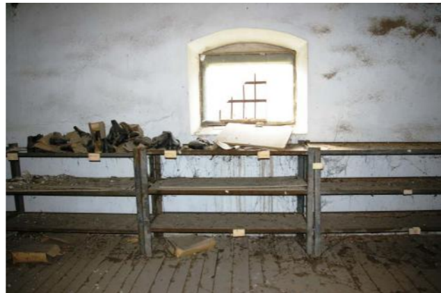
Abb. 66 Wandverfärbung des Obergeschosses (K-06)
