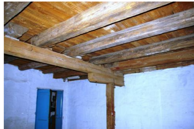
Abb. 73 Verfaulene und verfärbte Balken im Erdgeschoss (K-05)
