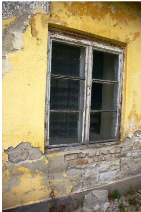
Abb. 121 Abplatzung des Putzes, Abblättern des Holzes (Ost)
