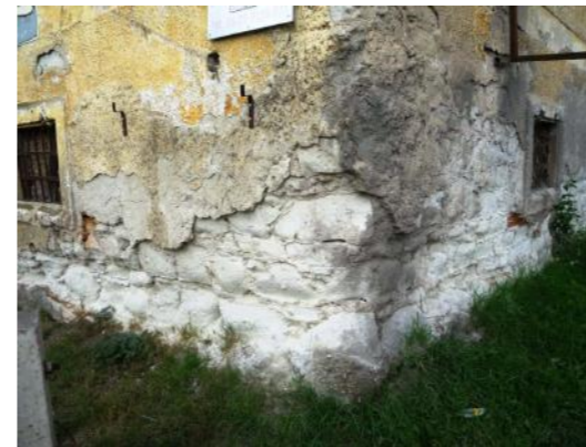
Abb. 50 Abgeplatzte Gebäudekante (Südost)
