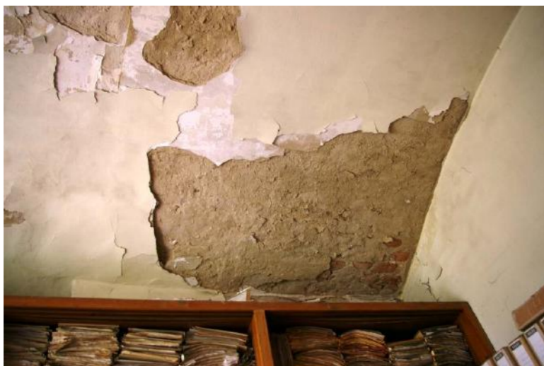
Abb. 248 Starke Putzoberflächenabplatzung an der Decke (S-09)
