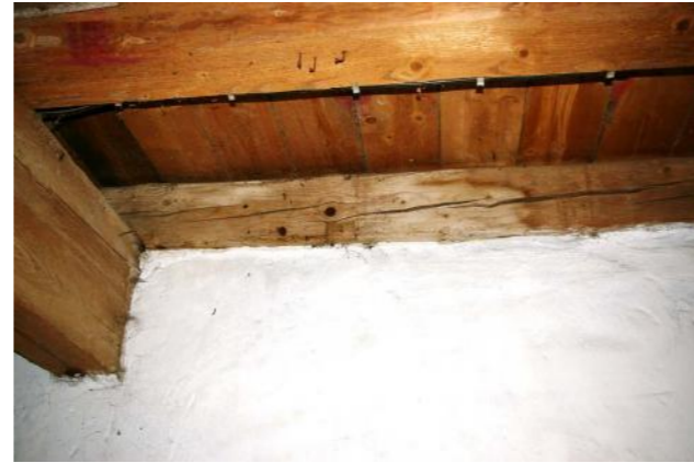
Abb. 72 Tragebalken mit Risse (K-05)
