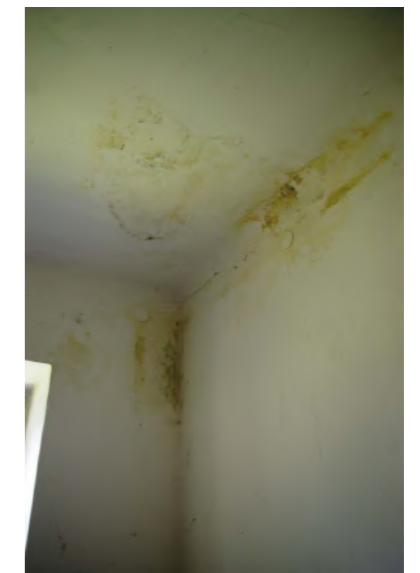
Abb. 140 Verfärbung der Decke (H-06)
