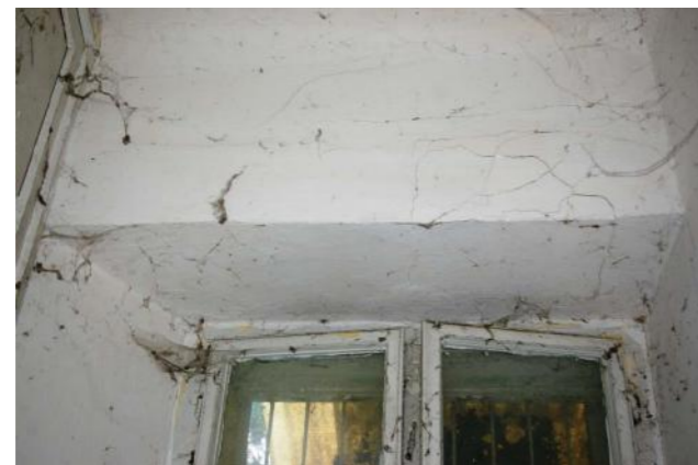
Abb. 134 Aufgetretene Risse auf dem Unterzug (H-02)
