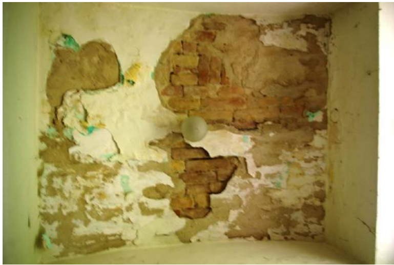
Abb. 246 Abgeplatzter Putzgrund der Decke (S-01)
