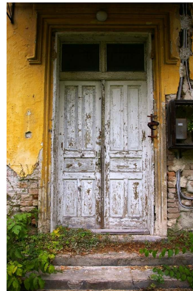
Abb. 230 Abgeblätterte Farbe der Eingangstür
