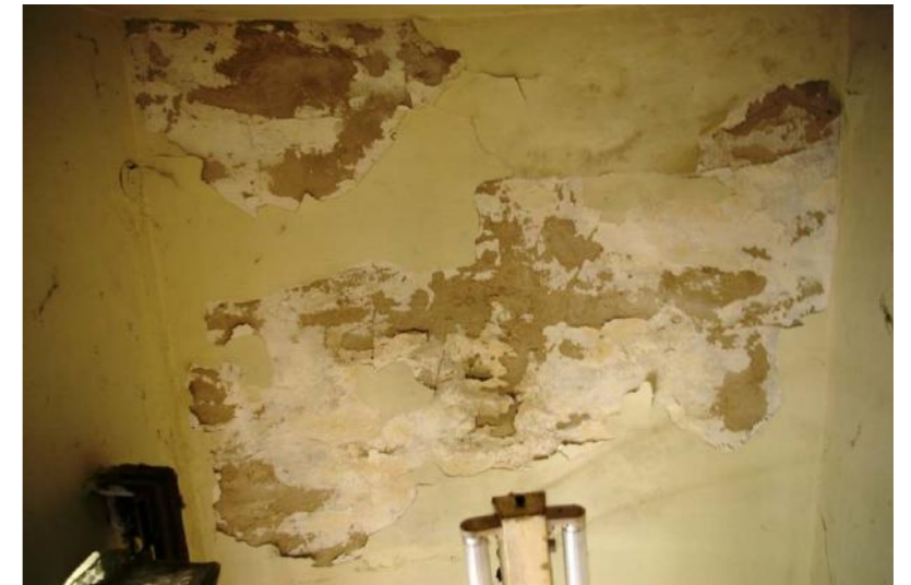
Abb. 243 Abgeplatzte Putzoberfläche an der Decke (S-10)
