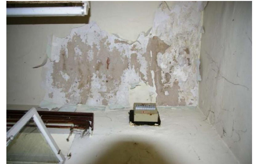
Abb. 244 Abgeplatzte Putzoberfläche an der Decke (S-02)
