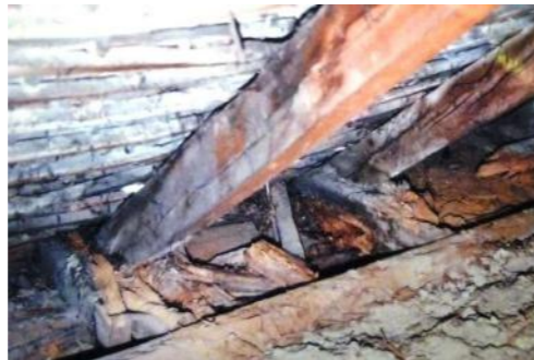
Abb. 113 Beschädigtes Holz des Daches
