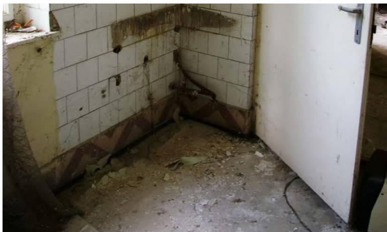
Abb. 236 Abgelöster Bodenbelag (S-03)
