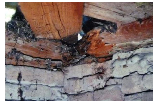
Abb. 221 Verfaulte Holzelemente (Süd)
