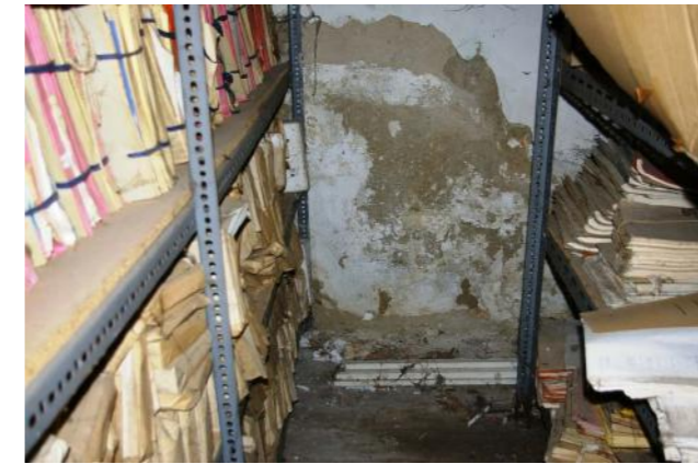
Abb. 136 Abplatzung der Putzoberfläche (H-14)
