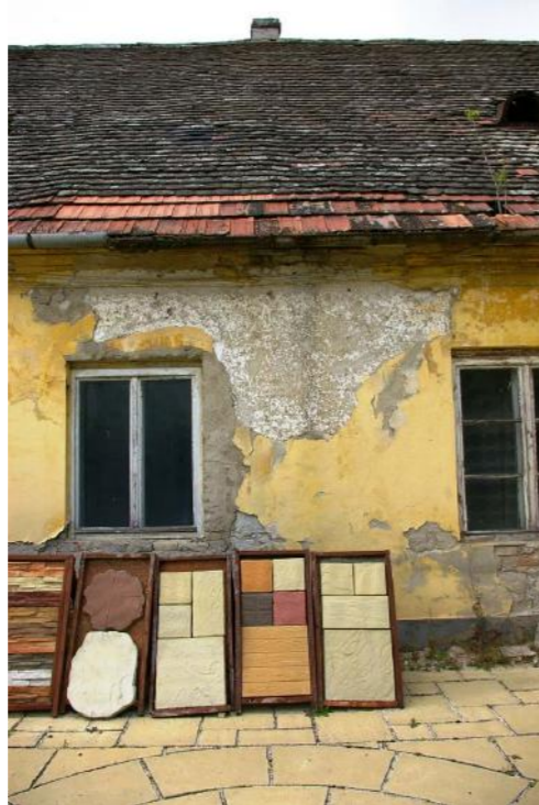
Abb. 120 Stark abgeplatzte Putzoberfläche (Ost)
