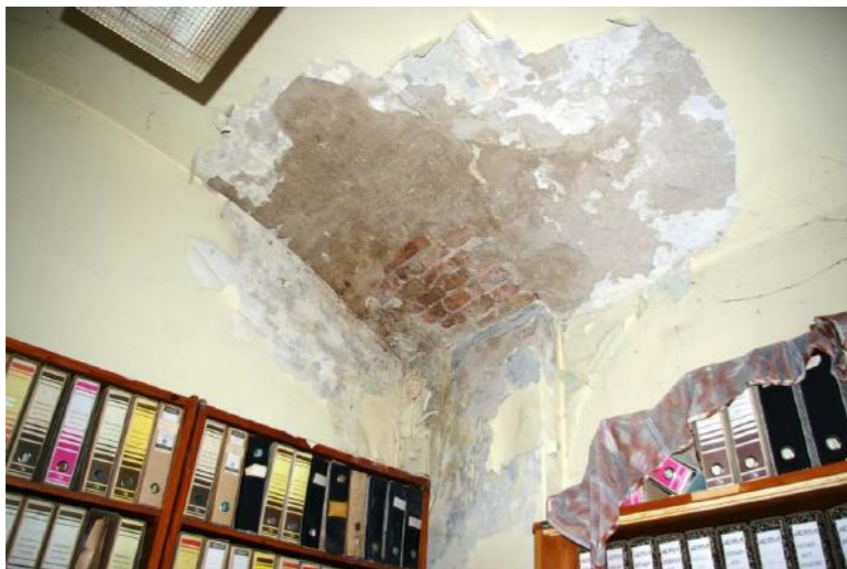
Abb. 247 Wesentliche Putzabplatzung an der Decke (S-08)
