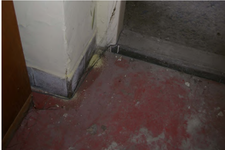
Abb. 235 Verfärbte Linoleum (S-08)
