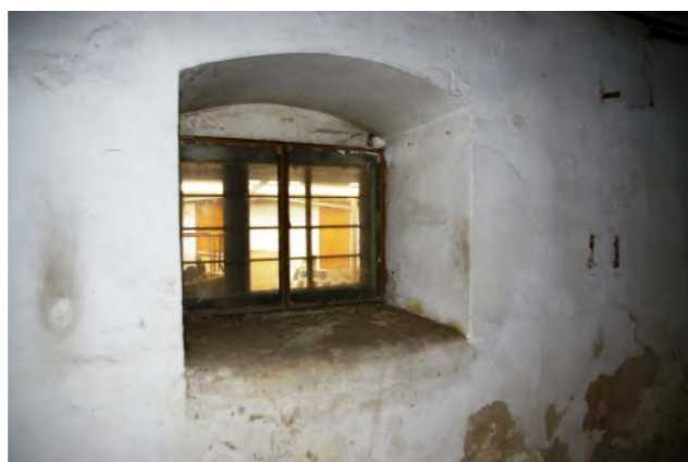
Abb. 64 Verrostene Fensterrahmen (K-05)
