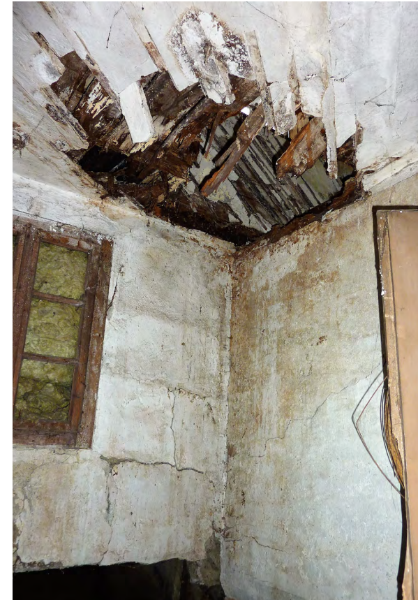
Abb. 139 Morsche Decke zwischen Erd- und Obergeschoss
