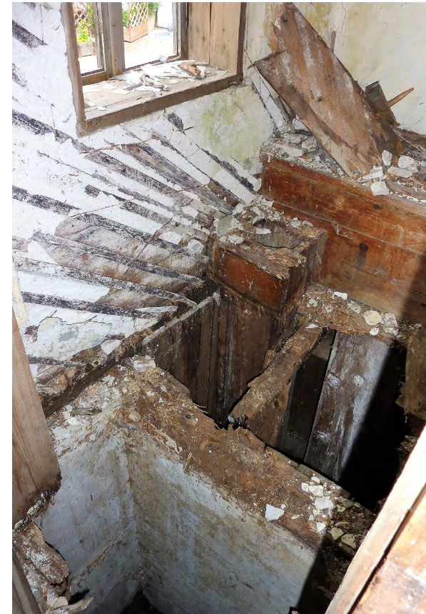
Abb. 143 Durchgebrochener Boden in der Trockentoilette
