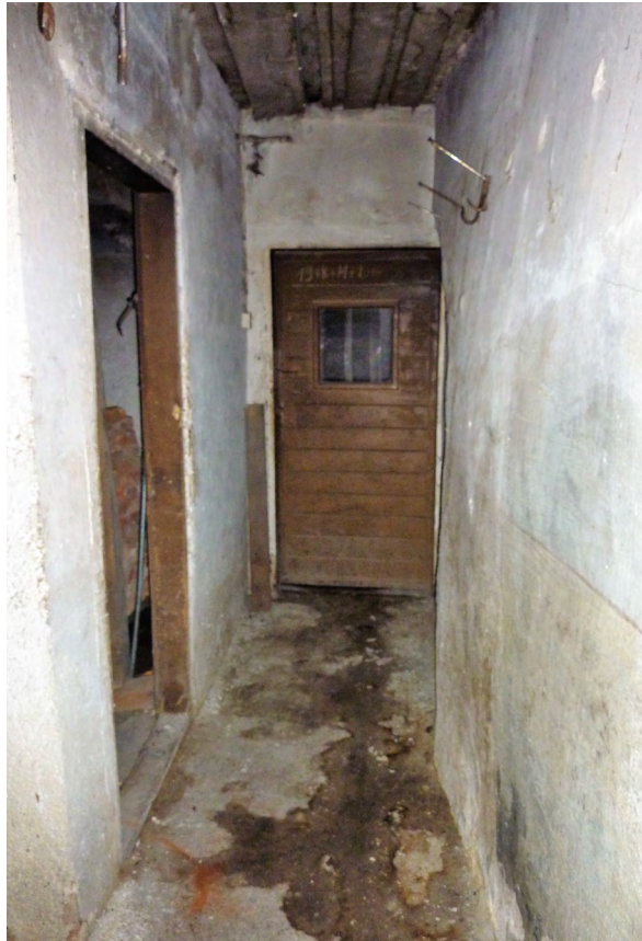
Abb. 138 Verformte Wand im Gang
