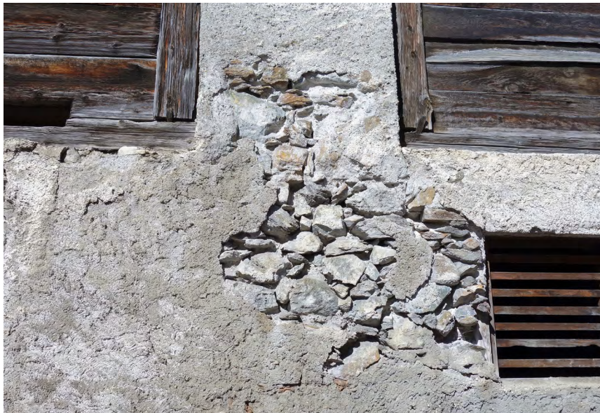
Abb. 146 Abgeblätterter Putz an der Fassade
