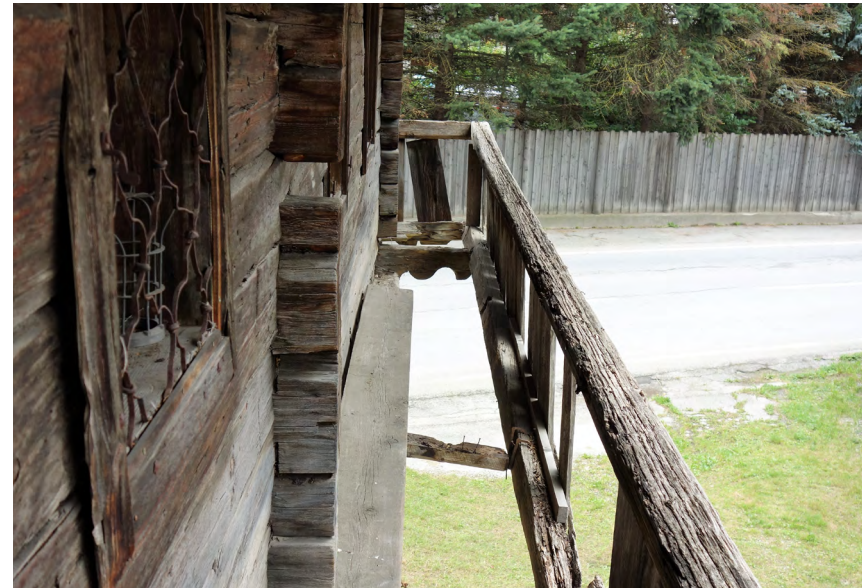
Abb. 107 Gank vor der Sanierung im Sommer 2016
