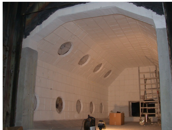
Bild 3.1: Herdwagenofen in der Wärmebehandlung der Stahlindustrie (49)
