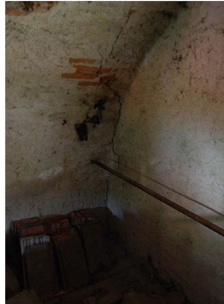
Abb.126 Riss zwischen Wand D und A
