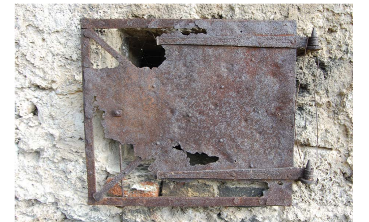
Abb.236 Verwitterter Fensterladen mit sichtbarer Tragstruktur in Hrboltová
