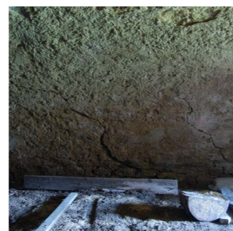
Abb.80 Wölbungsrisse in der Wange C
