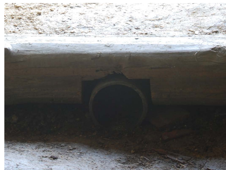
Abb.90 Wasserabflussrohr unter der Türzarge
