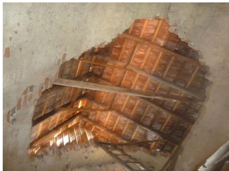
Abb.115 Loch im Gewölbe
