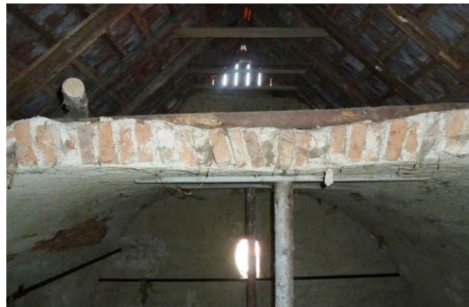
Abb.134 Die Unregelmäßigkeiten des Ziegelgewölbes
