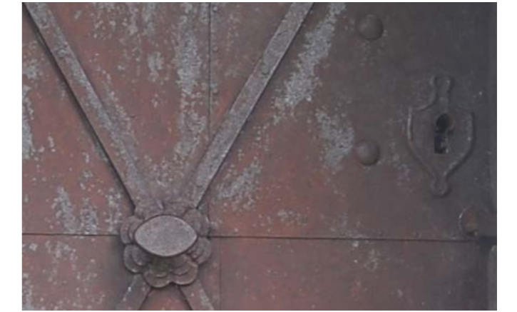
Abb.235 Nahaufnahme der zusammengesetzten Bleche, des dekorativen Handgriffs und Schlüsselloches an der Tür in Liptovská Kokava
