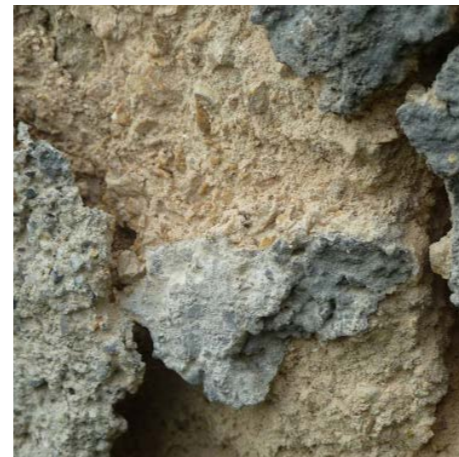
Abb.57 Abblätterungen des alten Zementputzes im Bereich des Sockels
