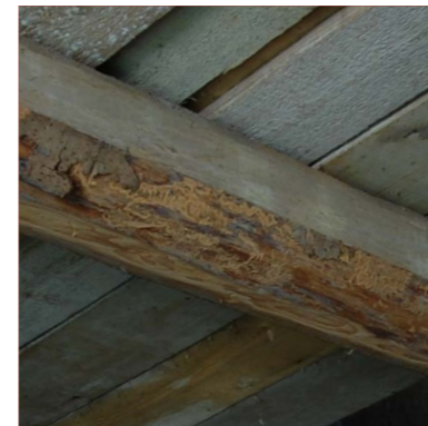
Abb.112 Detail vom Befall durch Borkenkäfer
