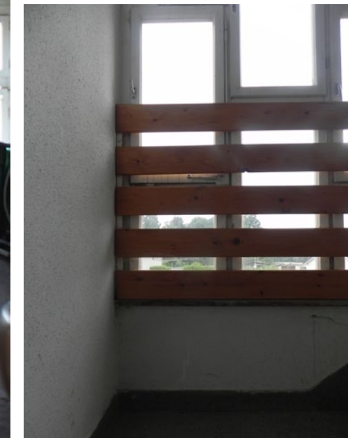
ABB. 85 Raum 3, Absturzsicherung bei Zwischenpodest I.
