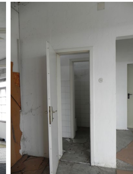
ABB. 37 Blick auf die Achsen 4 bis 5 mit elektrischen Betriebsraum.
