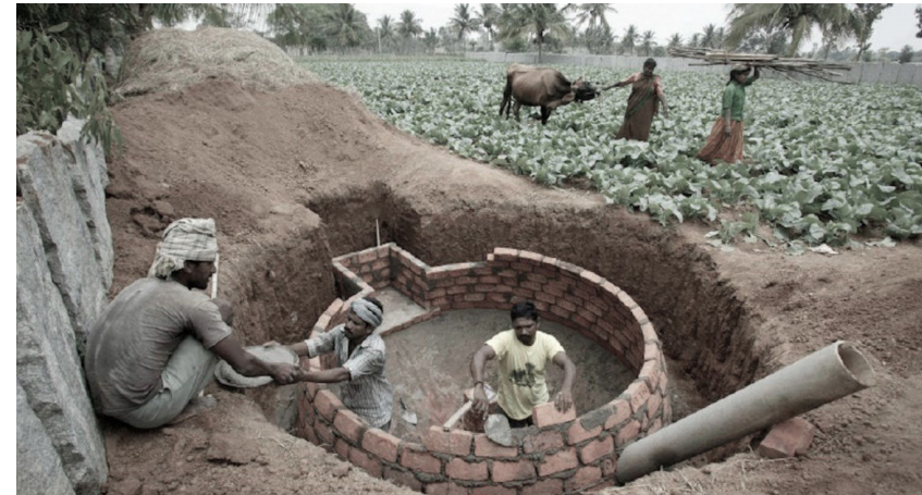
Abb. 158. Typische Ausführung eines kleinen Biogastanks in Indien
