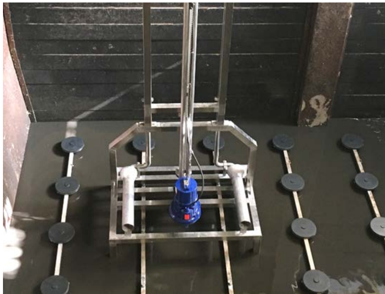
Abbildung 6: Anordnung des Offgas-Eintrages ins Biologiebecken der KA Neugut. 2016.
