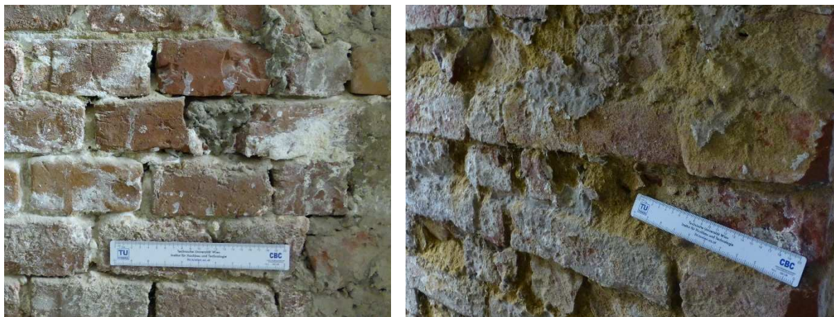
Abb. 1.5: Schadensbilder an gründerzeitlichem Mauerwerk [Aufnahme des Autors]
