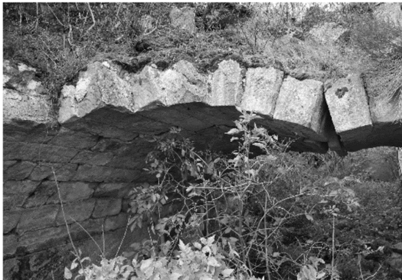
Abb. 4.8: Sehr große Auflagerverschiebung an einem Tonnengewölbe, Burgruine Altenstein, Unterfranken [113]
