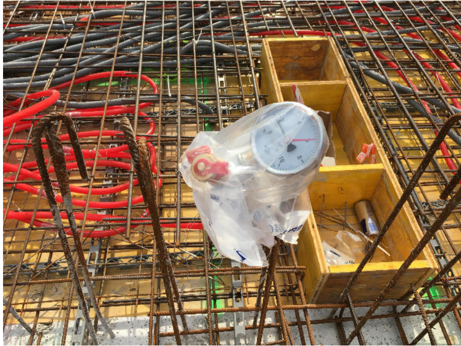
Abbildung 44: Detailfoto - Manometer Druckprüfung
