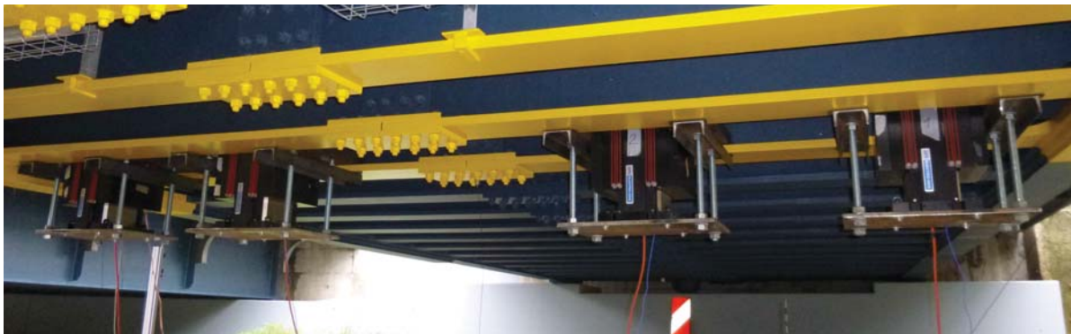
(c) Positionierung der Shaker; hier dargestellt: Tragwerk Gleis 4, Blick Richtung Leobersdorf
