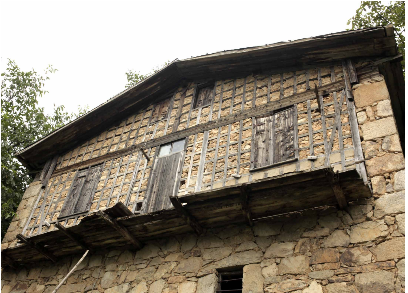
Yağcılar: haus 1 Balkon ohne Geländer
