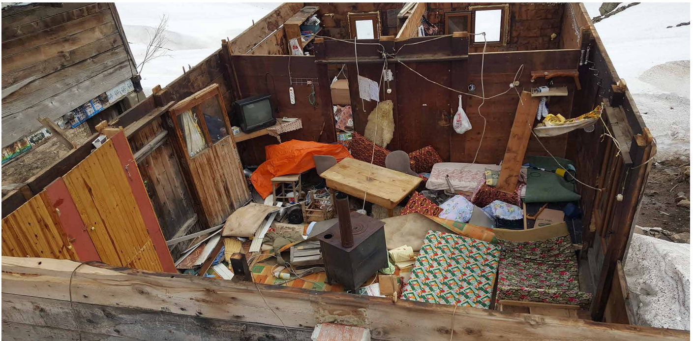
Cagrankaya Yaylasi: vom Wind zerstörte Dachkonstruktion
