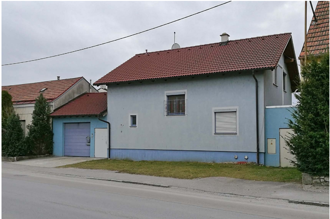
Abb. 51: War diese Fensteranordnung geplant? Außerdem wurde der Sinn der geschlossenen Bauweise nicht verstanden.
