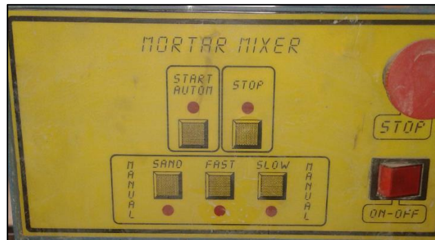
Abbildung 37: Einstellungen des Mörtelmischers
