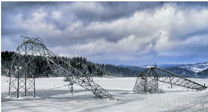
Abbildung 10: Umgeknickte Strommasten durch Eisregen und Schnee in Slowenien
