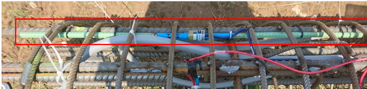
Abb. 4.37: Foto – eingebauter Bewehrungssensor Modell 4911 (Sister Bar) der Fa. Geokon [73]
