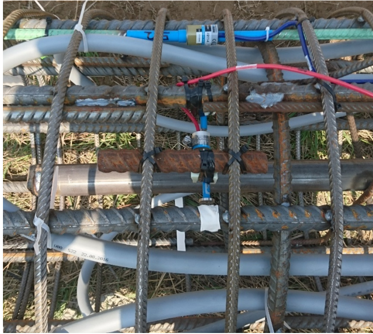
Abb. 4.39: Installierte Dehnungssensoren im Miozänpfahl B.EM – Fa. Geokon (Modell 4200)
