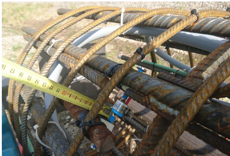
Abb. 4.40: Lage der installierten Dehnungssensoren im Miozänpfahl B.EM – Fa. Geokon (Modell 4200)
