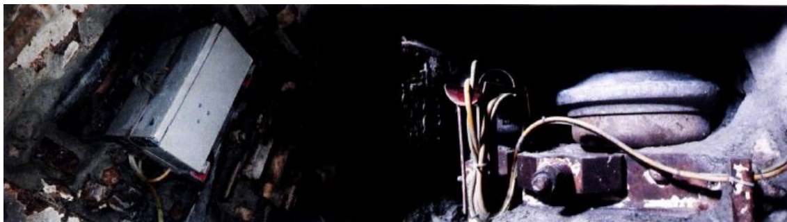
Abb. 5.12: Montage der Steuereinheit in den Diskenkästen der Doppeldisken (links) und Installation der Kameraeinheit im Diskengehäuse (rechts) [58]
