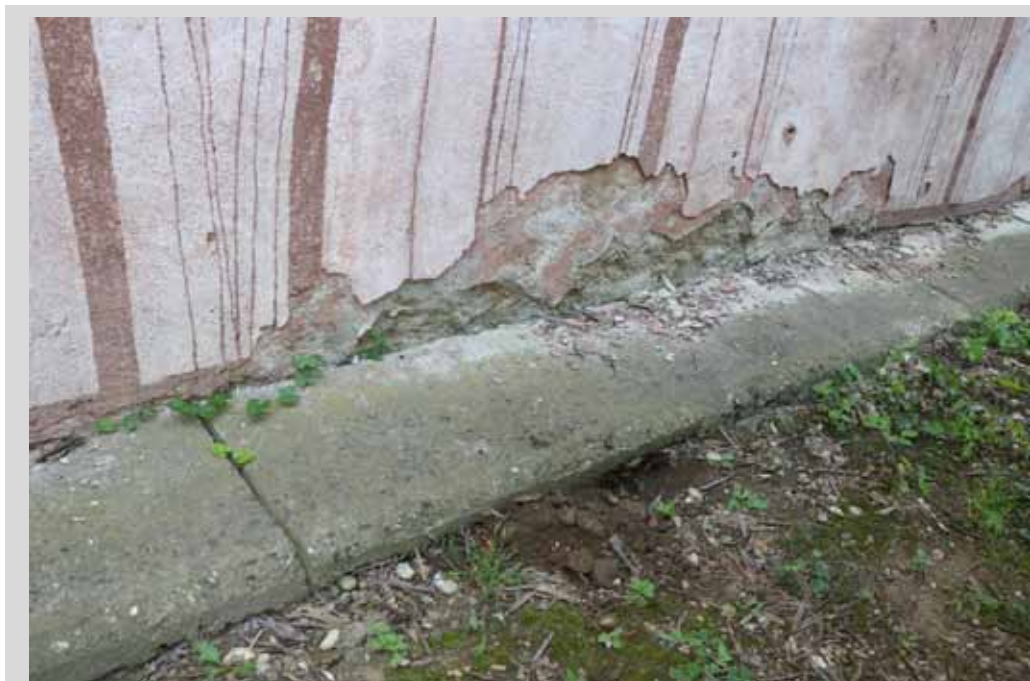
Verluste in der Sockelzone, Betongussplatten
