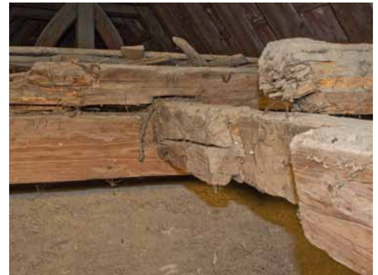
Abb.96: Abmorschungen und fehlende Bauteile im Nordtrakt (Türk, 09.04.2018)
