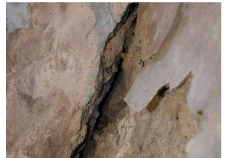
Abb.91: Rissbildung zwischen Nordwand und Gewölbe in EG_05 (Türk, 27.03.2018)
