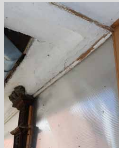
Sekundäre Verwendung der Führungsschiene an der Decke für eine „Verglasung“ Ende 20. Jh.
