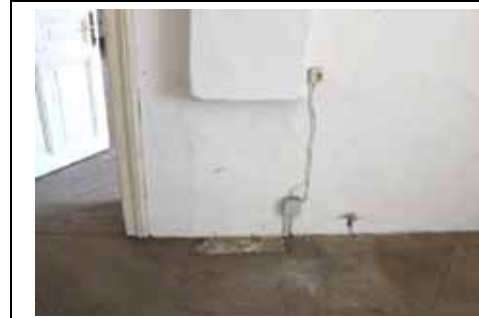
Sekundär abgetragene Gewölbeansatzbasis
