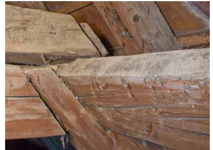
Abb.94: Fehlende kraftschlüssige Verbindung im Nordtrakt (Türk, 09.04.2018)
