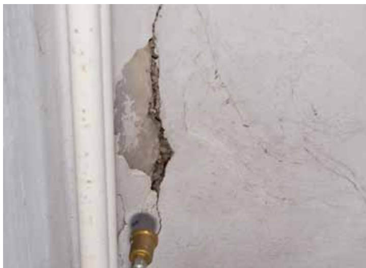
Abb.90: Riss an der Decke zur Nordwand in OG_15 (Türk, 31.03.2018)
