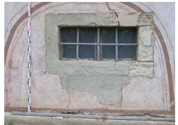
Abb.85: Schäden am Südfenster von EG_15 (Türk, 29.03.2018)
