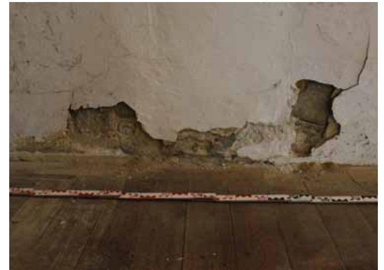
Abb.81: Schadstelle an der Südwand von OG_14 (Türk, 31.03.2018)
