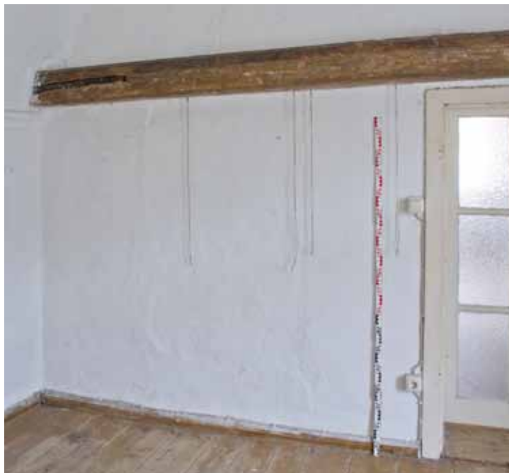
Abb.129: Holzbalken in OG_16 (Türk, 31.03.2018)
