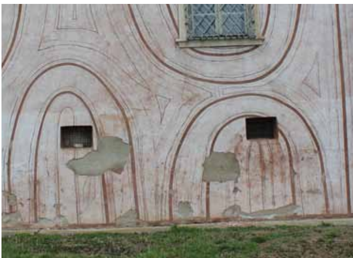
Abb.84: Schäden an der Südfassade (Türk, 31.03.2018)
