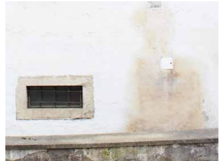
Abb.83: Schäden an der Nordfassade (Türk, 31.03.2018)
