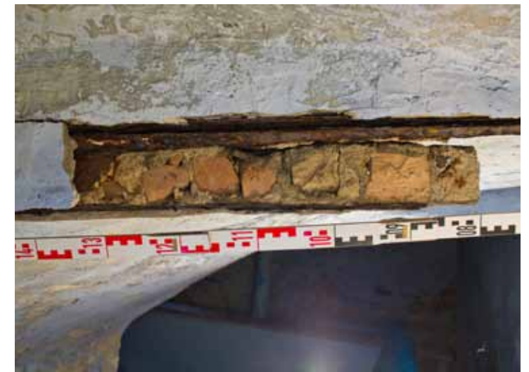
Abb.87: Stark korrodierter Eisenträger unter der Stiege in EG_02 (Türk, 27.03.2018)
