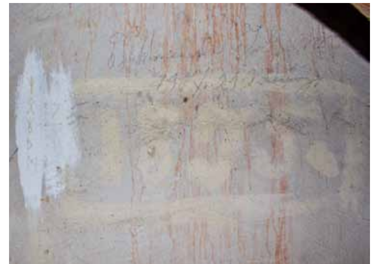
Abb.53: Signaturen an der nordöstlichen Brandwand (Türk, 09.04.2018)
