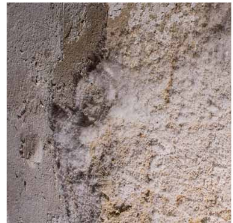
Abb.78: Versalzungen und Putzschäden in EG_08 (Türk, 28.03.2018)
