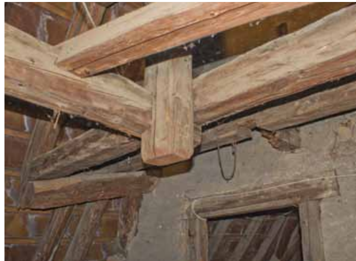
Abb.93: Unfachmännische Lösung im nordwestlichen Dachwerk (Türk, 09.04.2018)
