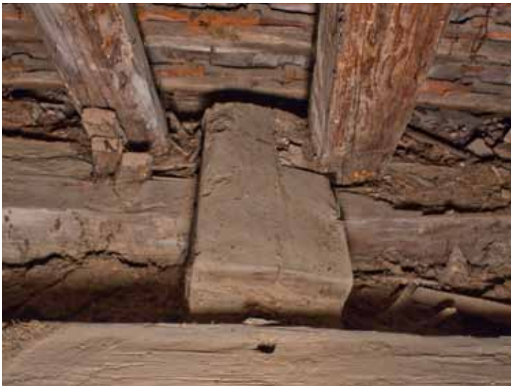
Abb.95: Fehlende kraftschlüssige Verbindung im Westtrakt (Türk, 09.04.2018)
