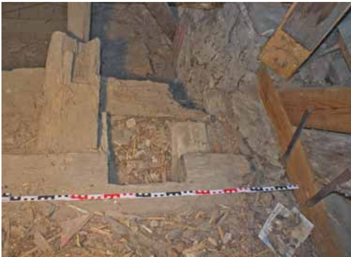
Abb.92: Abmorschungen im nordwestlichen Dachwerk (Türk, 09.04.2018)
