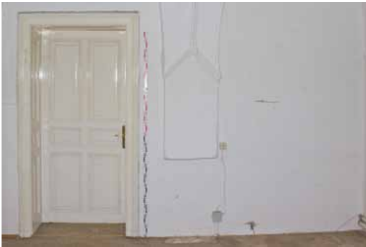
Abb.113: Fehlender Gewölbepfeilersockel in OG_12 (Türk, 31.03.2018)
