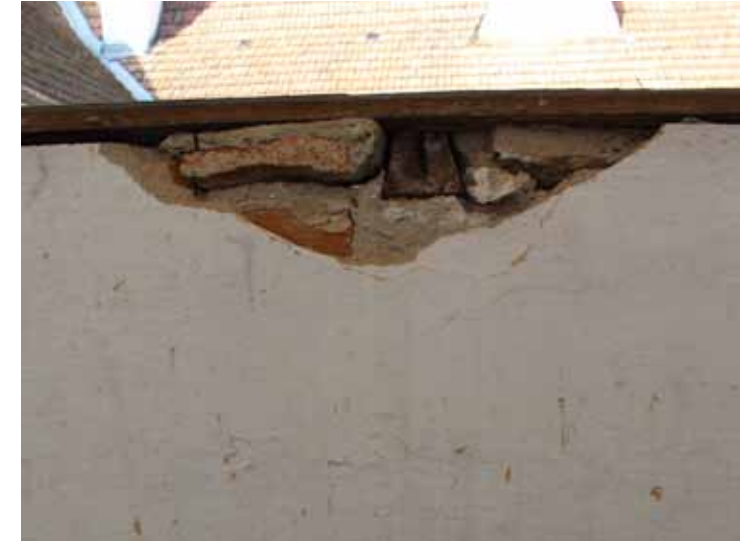
Abb.89: Schadhafte Brüstung im Osttrakt (Türk, 30.03.2018)
