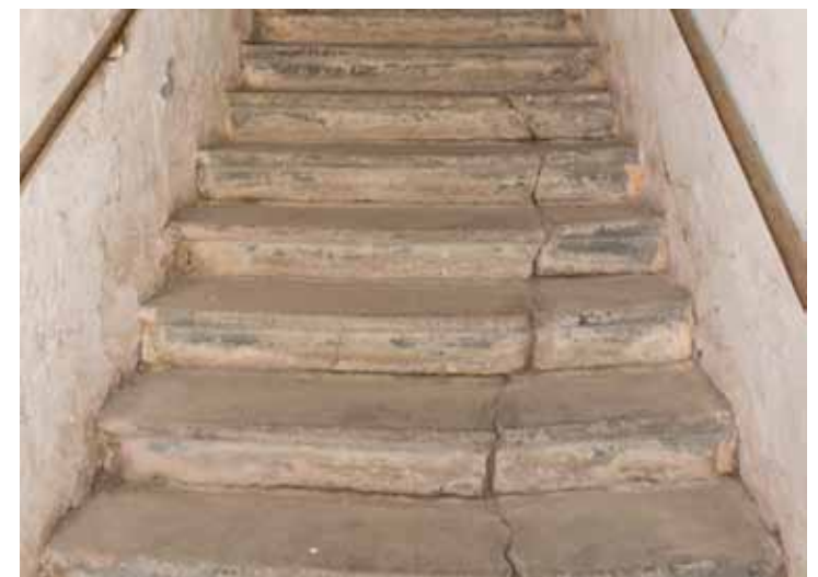
Abb.98: Gebrochene Betonstufen in EG_19 (Türk, 29.03.2018)
