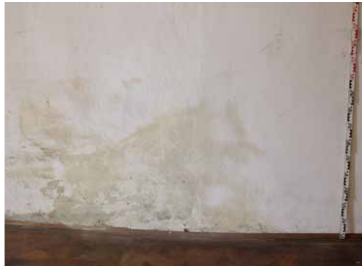
Abb.80: Putzschäden an der Südwand in OG_06 (Türk, 30.03.2018)
