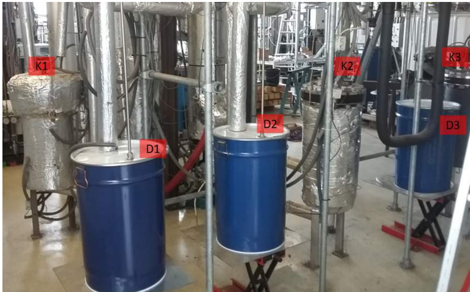
Abbildung 4.9: Kondensatoren (K1-K3) und entsprechende Drums (D1-D3)
