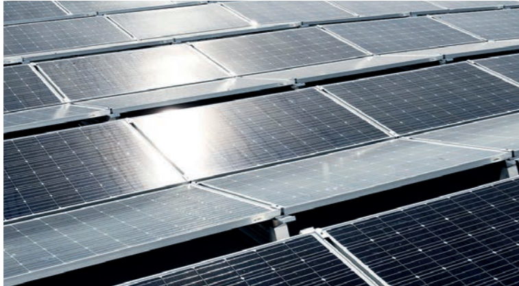
Abb. 84 Energieterrassen mit Photovoltaik-Paneelen zur Stromerzeugung
