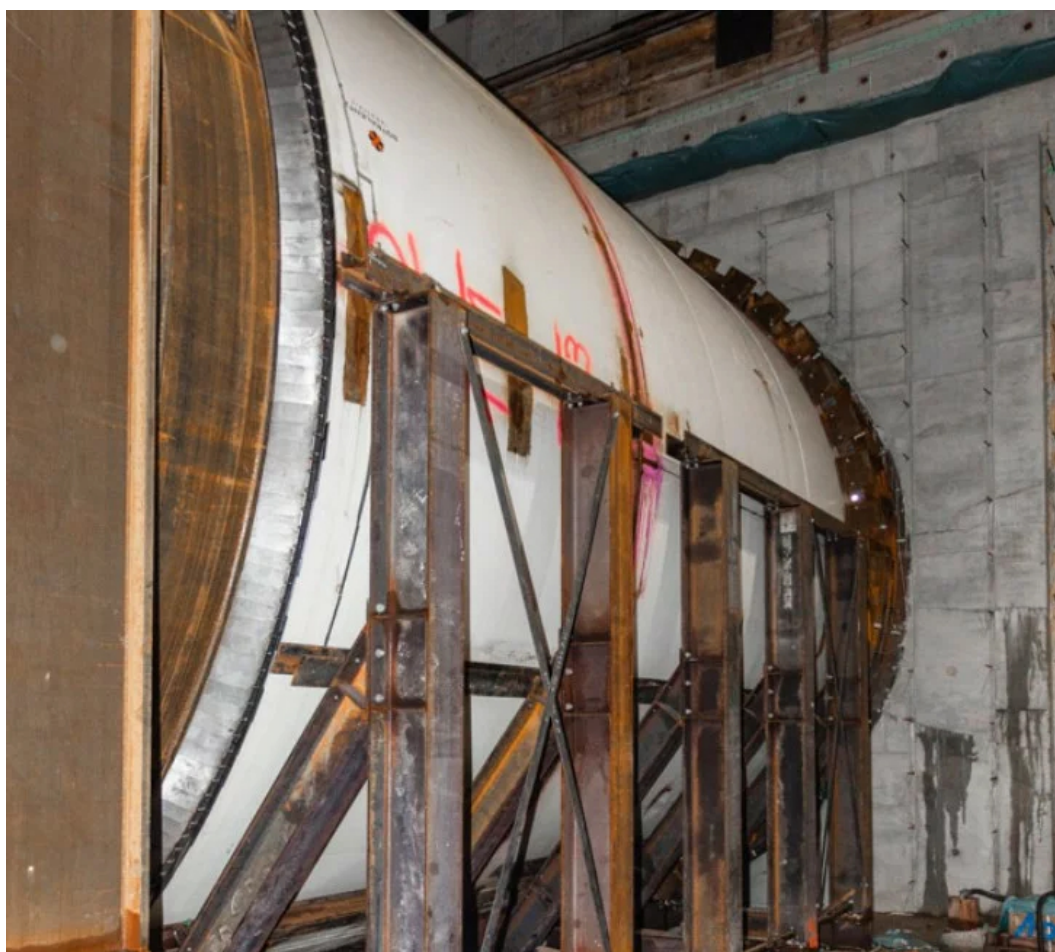
Abb. 3.3: Stahlkonstruktion zur Begrenzung der horizontalen Verformung der Blindringe (Quelle: [46] KREBS+KIEFER Service GmbH)
