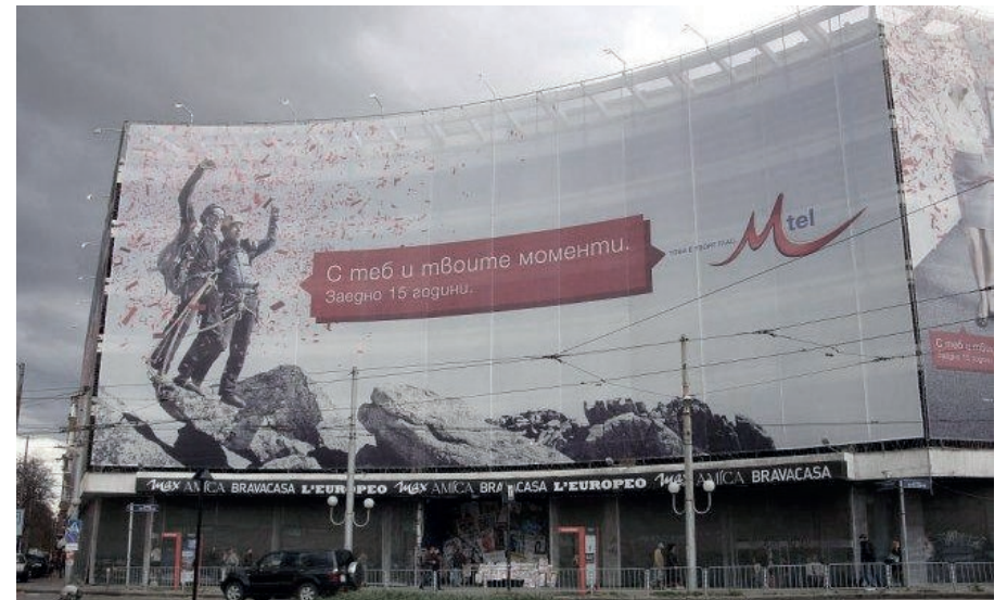
Abb.16 Die Fassade nach dem Brand
