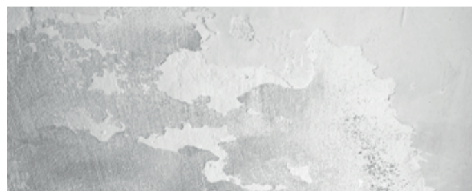
Abb.110 Feuchteschäden | Stelle 2 | Raum 12
