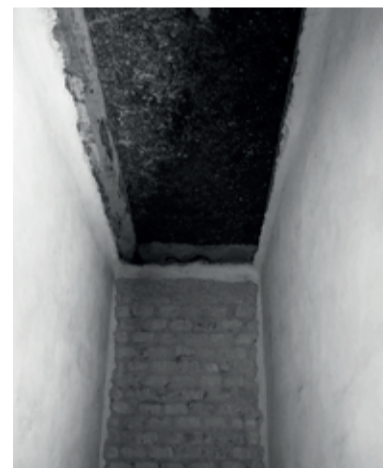
Abb.94 Beschädigte Decke | Stelle 1
