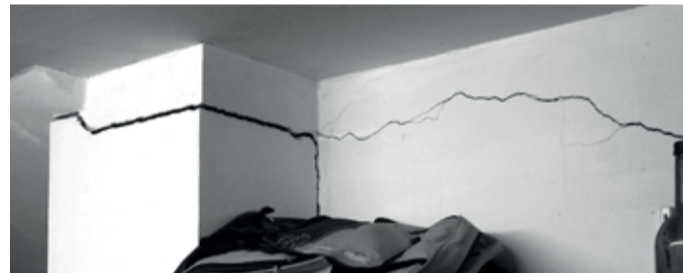
Abb.109 Riss | Stelle 1 | Raum 13
