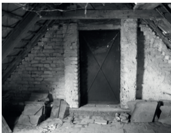
Abb.141 Blick c | Brandschutztür
