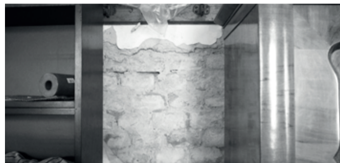
Abb.99 freiliegendes Mauerwerk | Stelle 1
