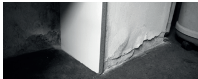
Abb.111 Feuchteschäden | Stelle 3 | Raum 13
