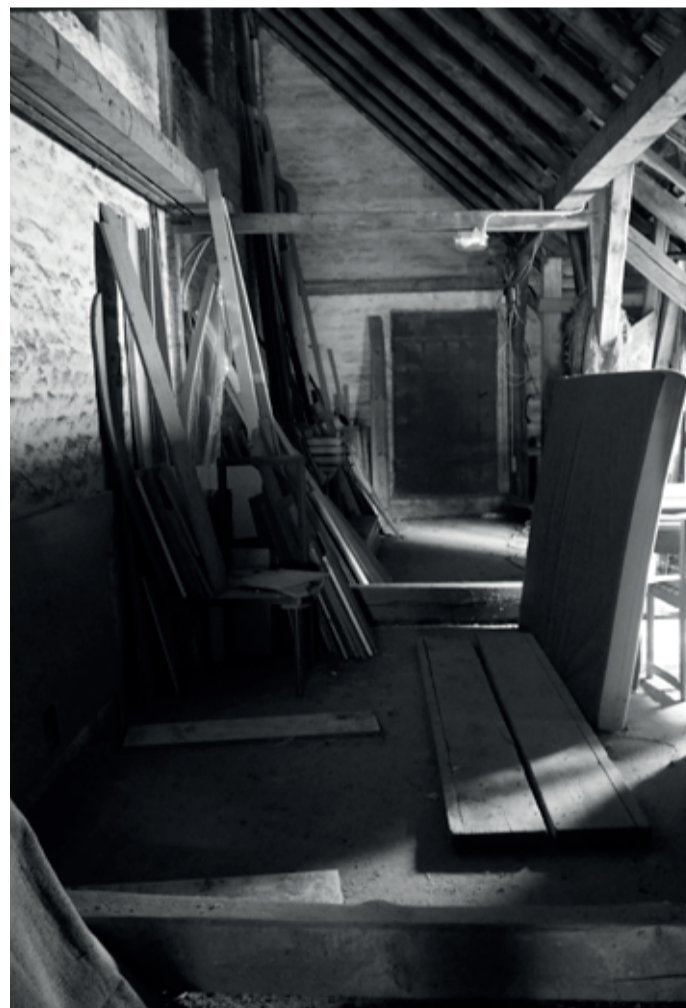
Abb.137 Blick b | beschädigte Doppelbaumdecke, mit Holz abgedeckt | Stelle 1
