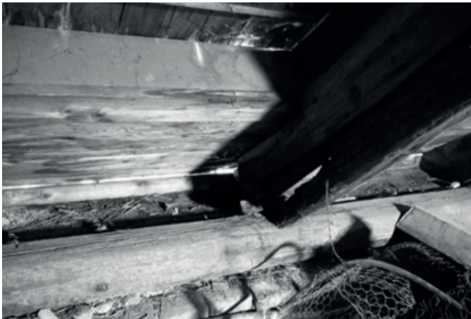
Abb.145 Beschädigte Holzkonstruktion | Stelle 1
