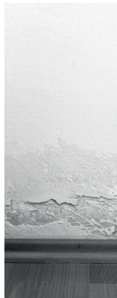
Abb.85 feuchte Innenwand | Stelle 1
