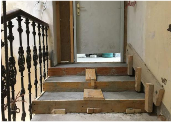
Abb. 24: Vermeidung Stolperunfall - Stufenangleichung
