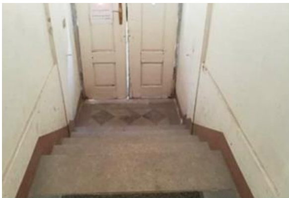
Abb. 7: Beispiel fehlender Handlauf - OIB-RL 4
