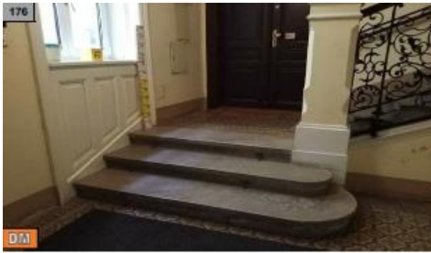
Abb. 11: Fehlender Handlauf lt. ÖNORM
