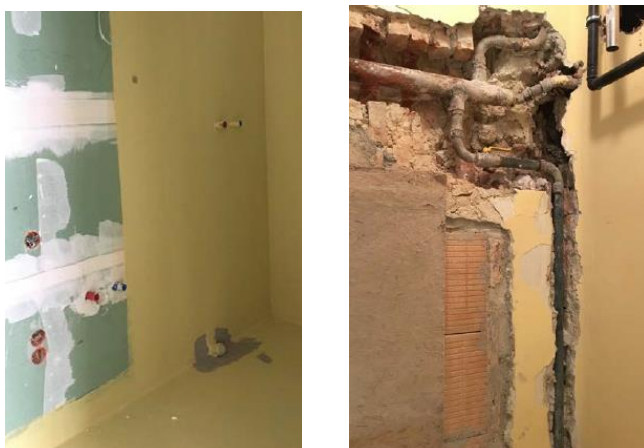
Abb. 22: Feuchtigkeitsisolierungen Bad / Sanierung Steigleitung
