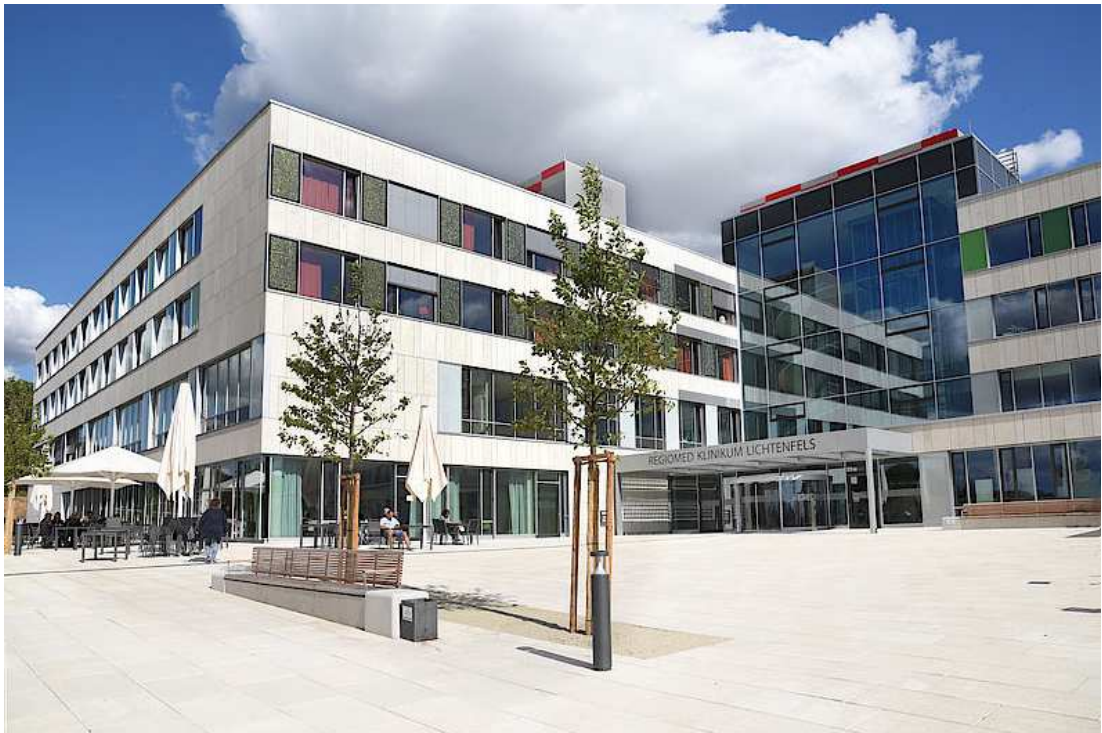
Abbildung 8: Im Klinikum Lichtenfels wurden Photovoltaikanlagen mit insgesamt 120 kWp installiert (Foto: Klinikum Lichtenfels)
