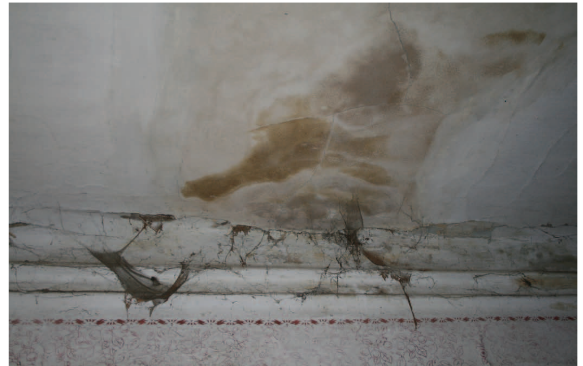
Übersicht 1.OG.26 Feuchteschäden an der Decke
