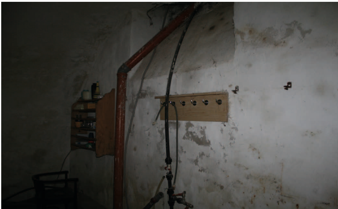
Abb.104: Feuchter Innenputz in EG.19, Nordwand = Außenwand
