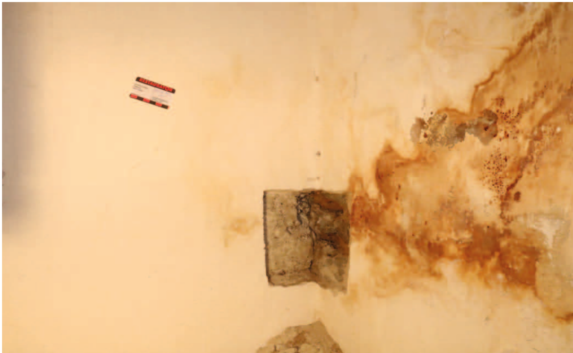
Abb.106: Feuchtigkeit an der Ostwand von EG.18 zum Raum EG.17
