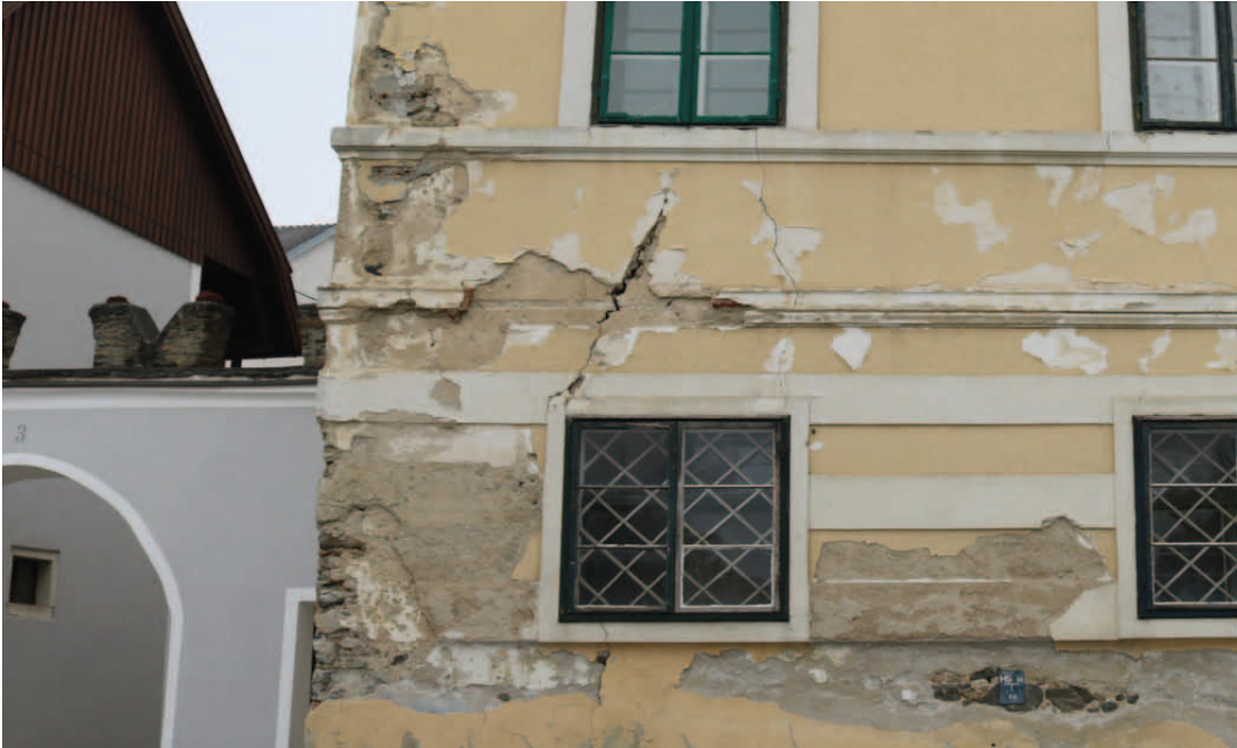
Abb.97: Westlicher Riss an der Südfassade
