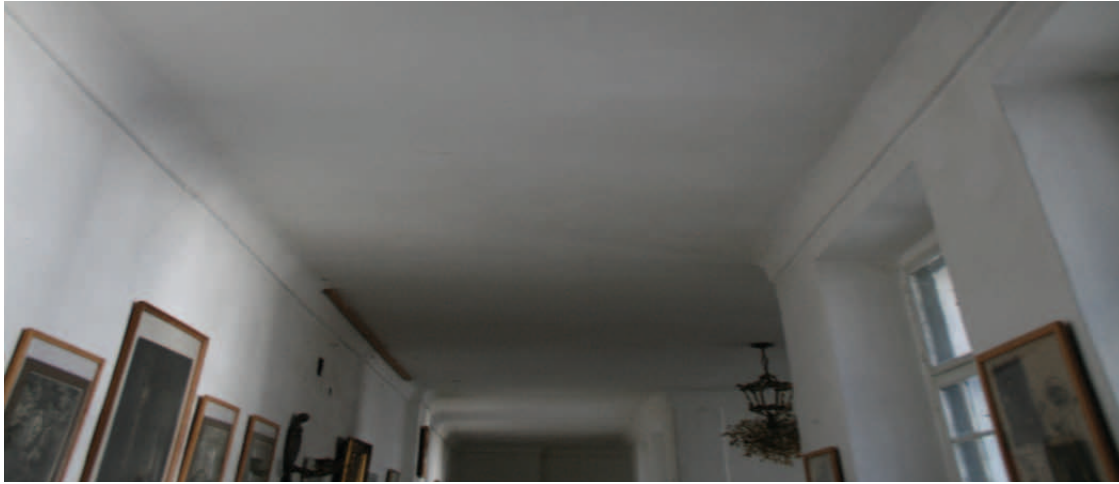
Übersicht 1.OG.01a Decke
