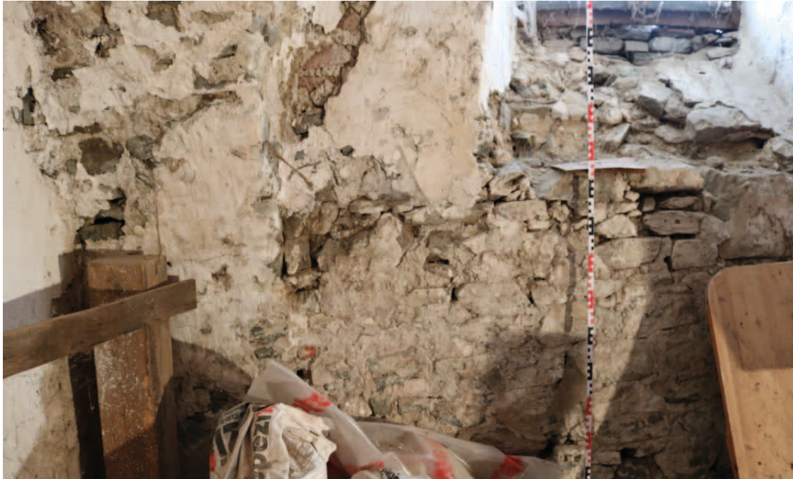
Abb.103: Feuchtespuren in EG.23, Westwand = Außenwand
