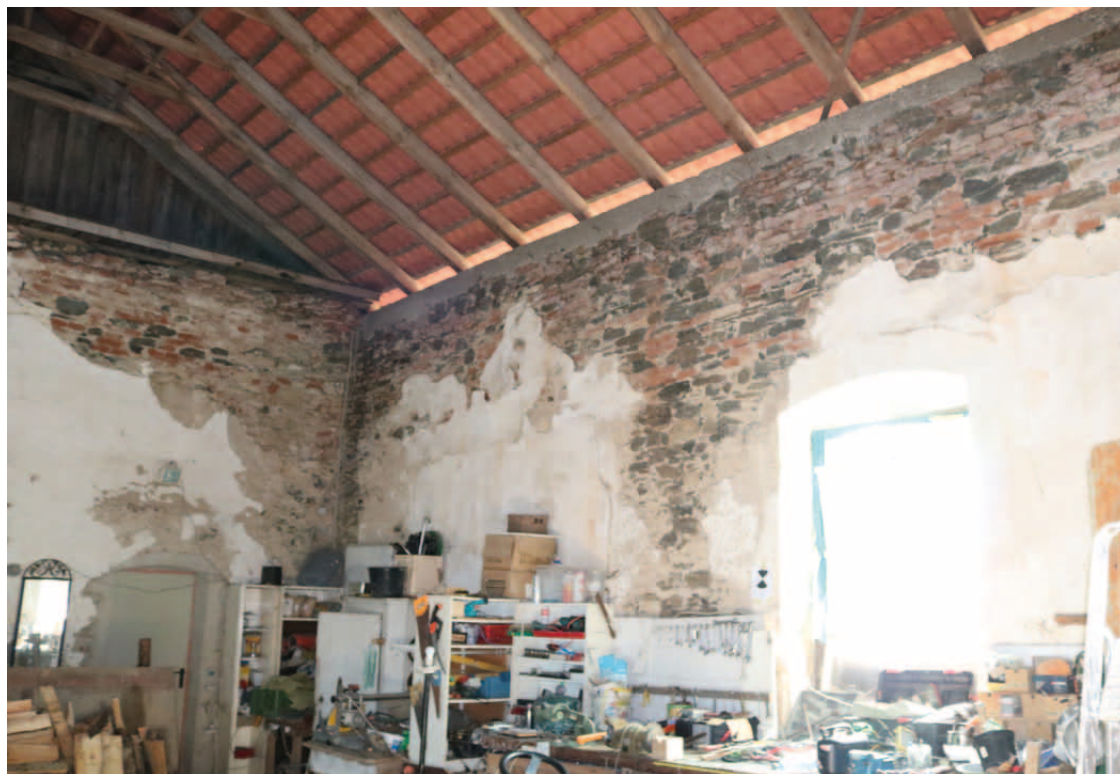
Abb.97: Kapellendecke nach mehreren Einstürzen und aufgemauerter Mauerbank
