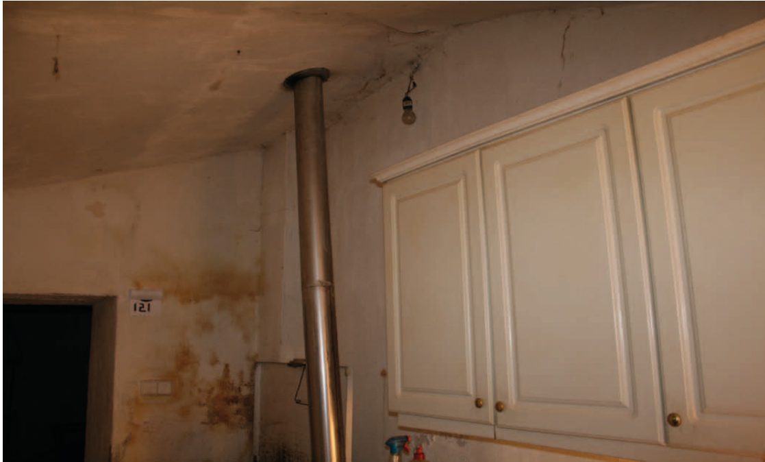
Abb.105: Feuchtespuren in EG.18, Deckenverkleidung ebenfalls bereits feucht
