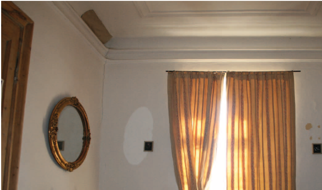
Abb.95: Riss im Innenraum, Zwischenwand 1.OG.03 zu 1.OG.02
