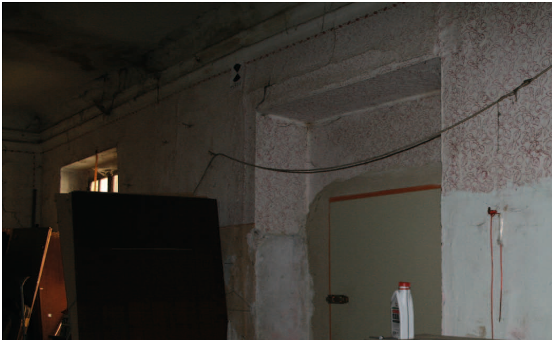
Abb.101: Decke in 1.OG.26 mit vergangenen und teilweise frischen Feuchtespuren
