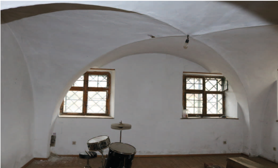
Abb.98: Innenraum EG.28 ohne Rissbefundung, somit ist der westliche Riss nur an der Außenseite
