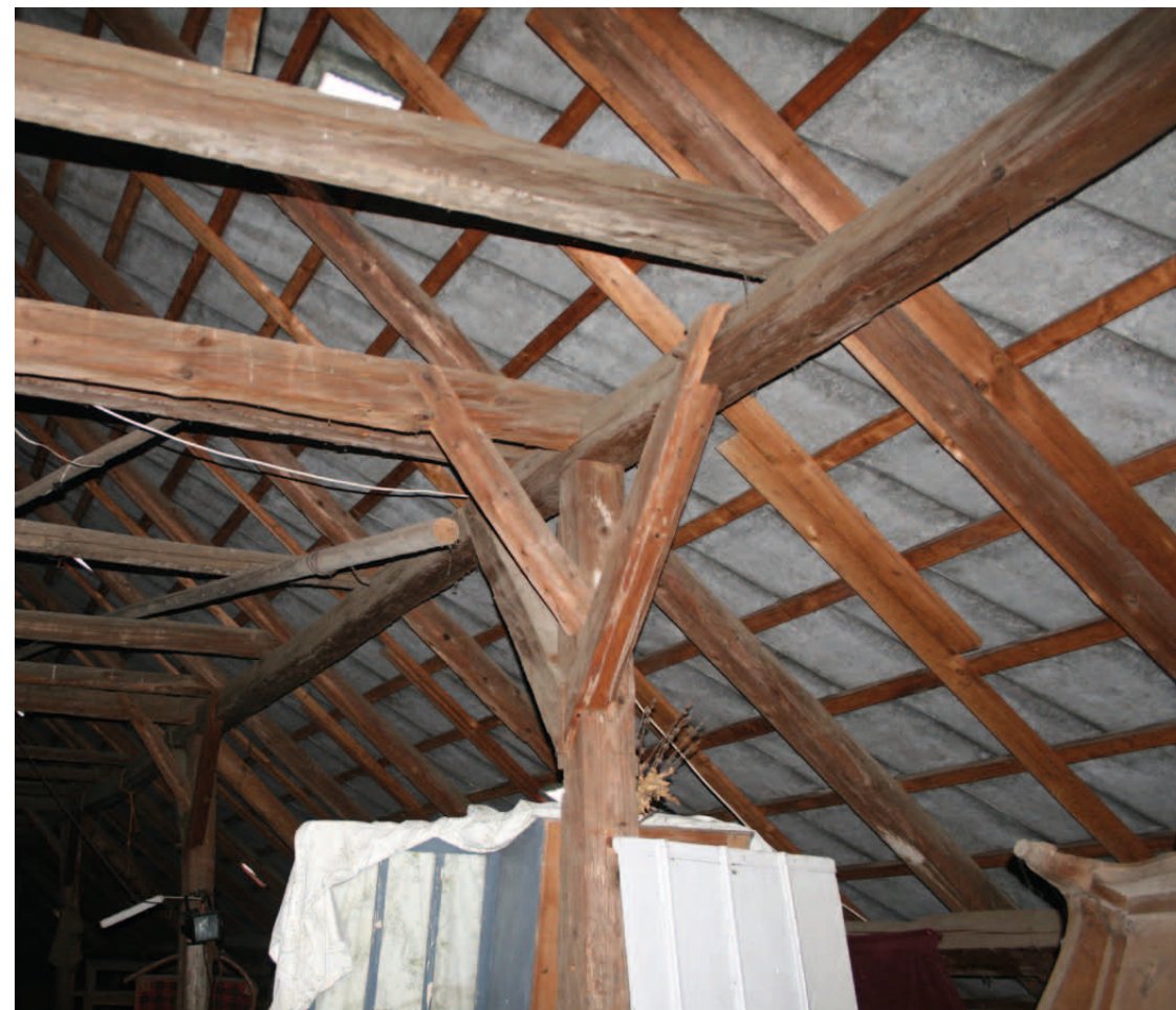
Abb.34: südliche Stuhlsäule mit Kopfbändern und sekundärem Tragsystem davor.
