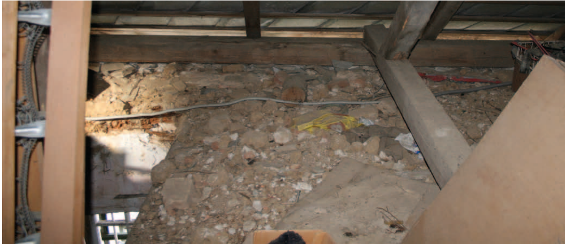
Abb.35: nördlicher Fußpunkt mit eingestürzter Decke, links am Bild
