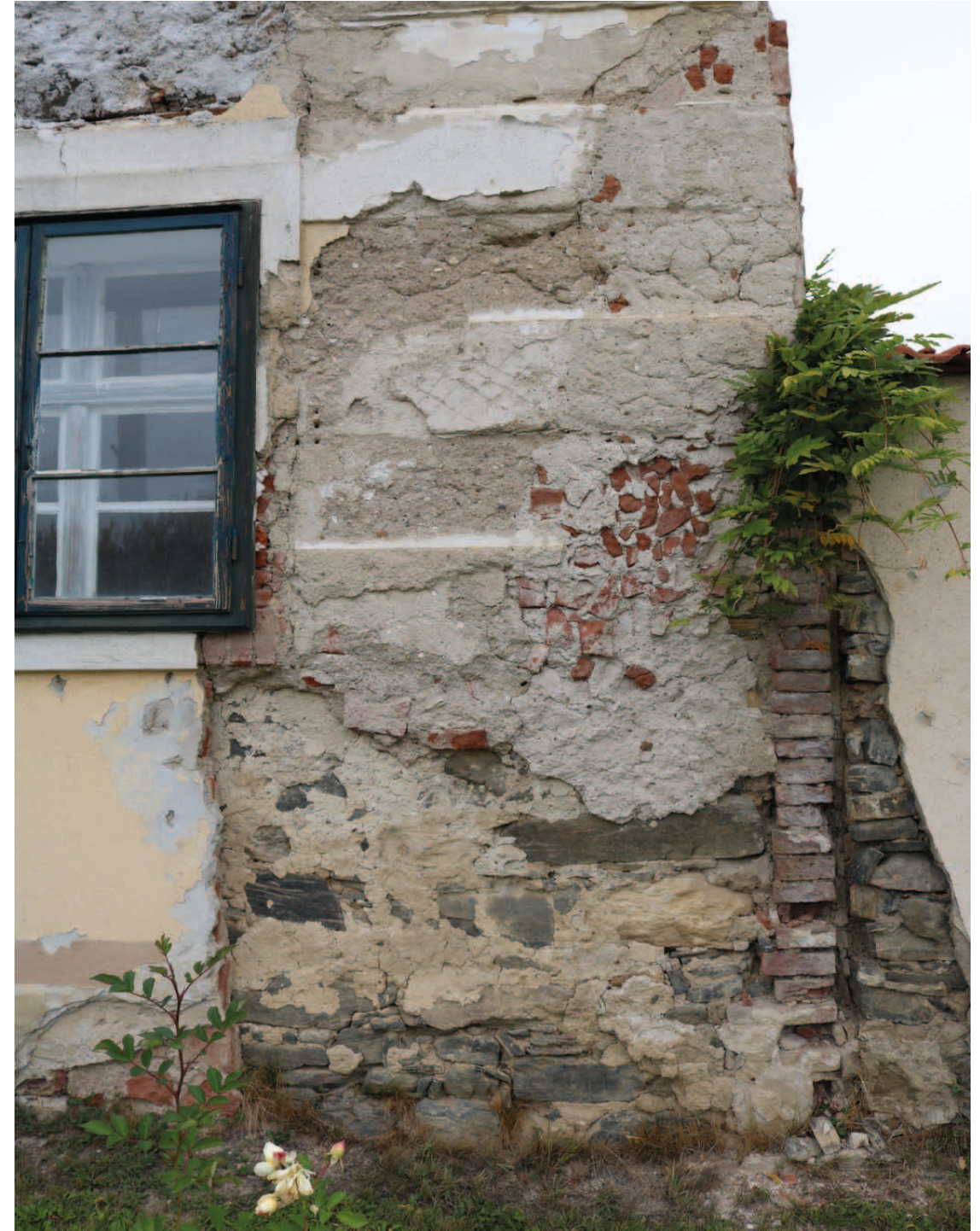
Abb.99: Grobe Abplatzung der Fassadenverkleidung
