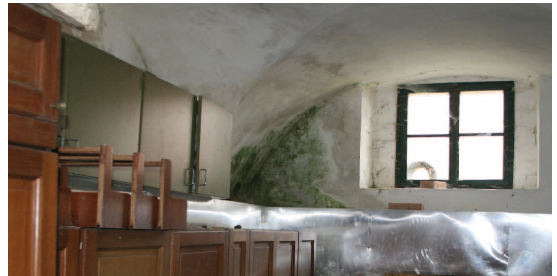
Abb.107: Feuchtigkeit und grünes Moos an beiden Außenwänden von EG.17
