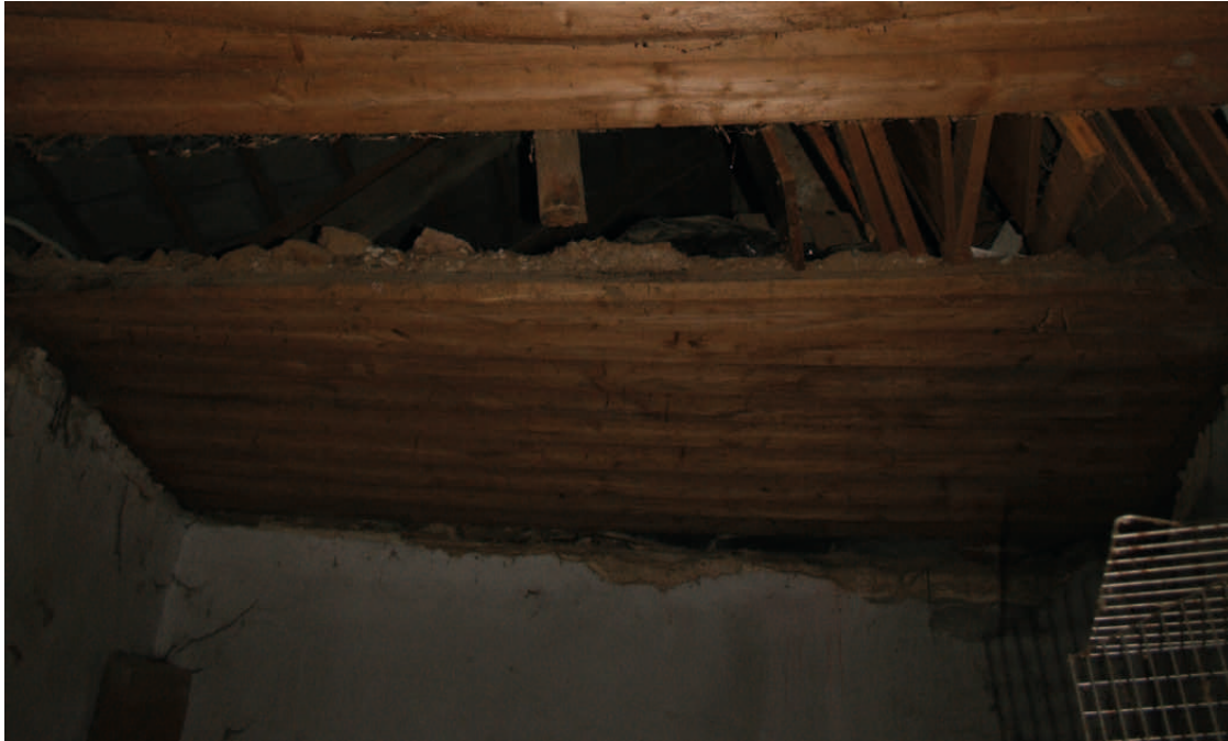
Abb.100: Doppelbaumdecke in 1.OG.25, bereits eingestürzt
