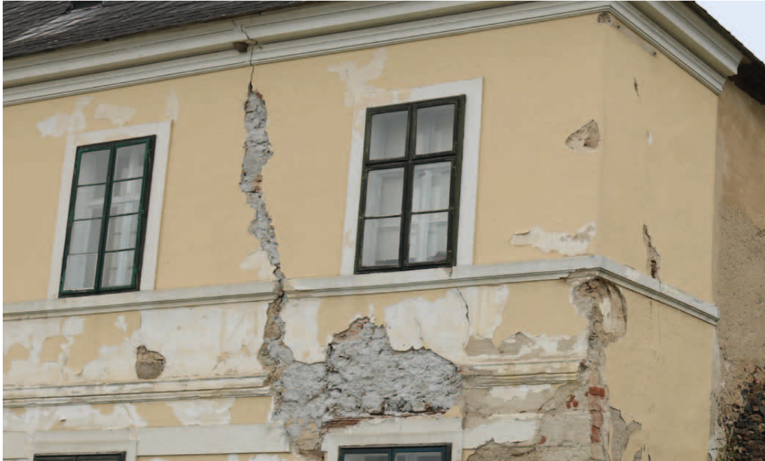
Abb.94: Riss an der Südfassade
