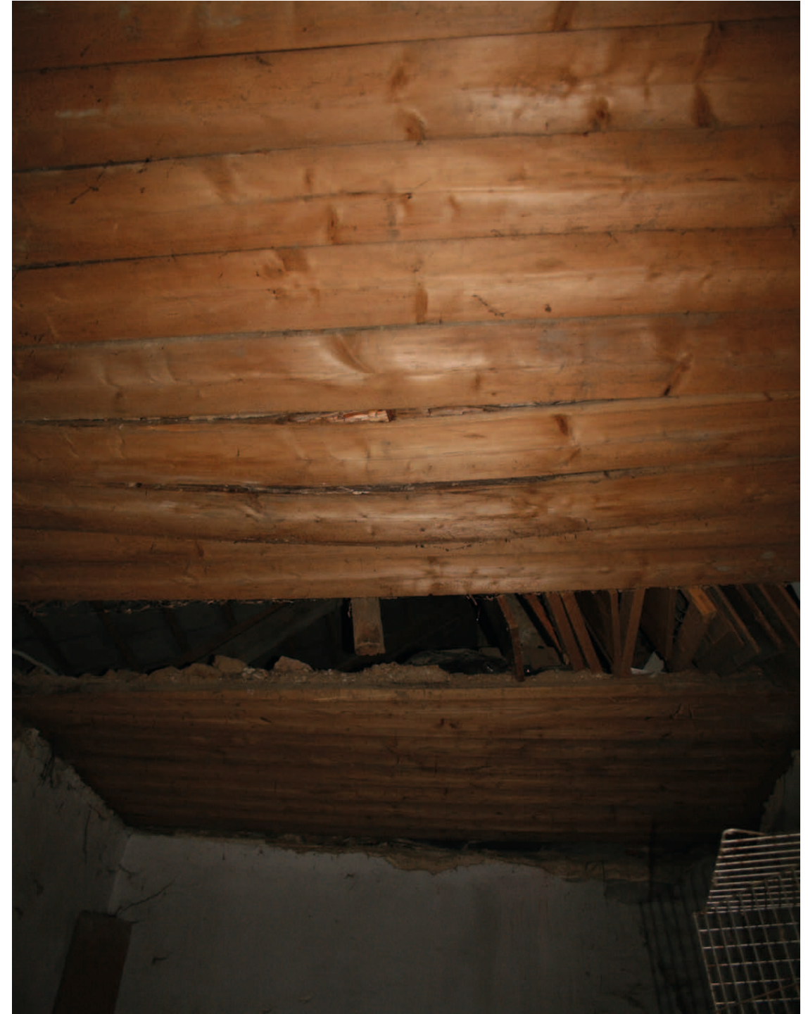
Übersicht 1.OG.25 eingestürzte Decke
