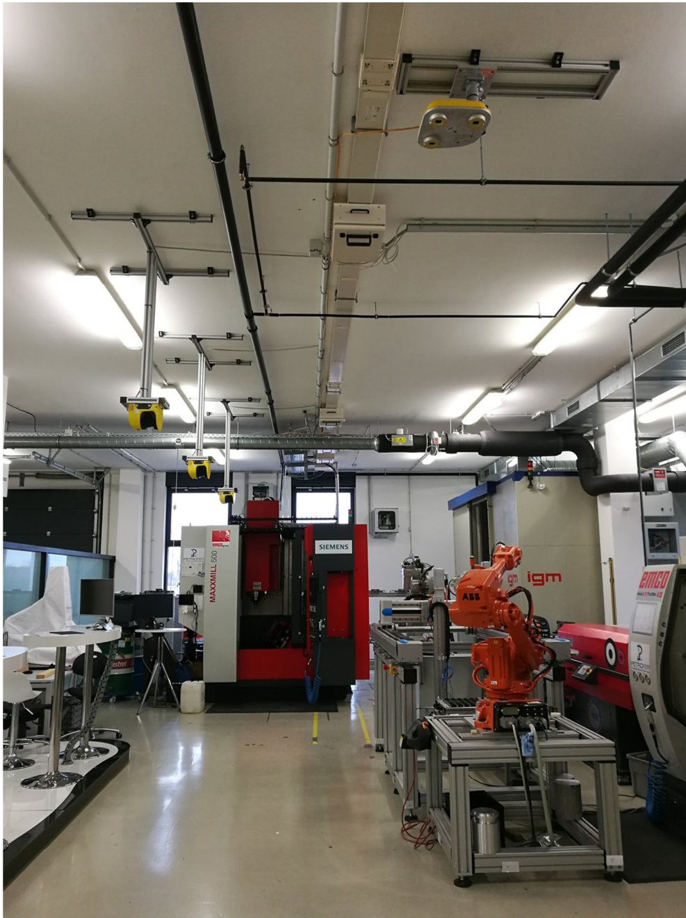
Abbildung 4.14: Laserscanner S3000 Advanced und Safety Eye an der Decke
