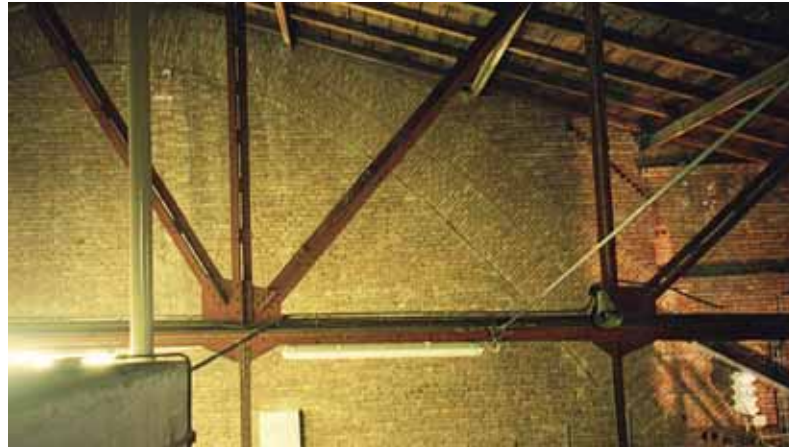
Abbildung 55 Parabolischer Bogen in der 90cm dicken Proszeniumswand über der Bühnenöffnung. Darunter befinden sich jeweils zwei Mauerschalen im Läuferverband. Nur diese Last muss vom Fachwerkträger über der Bühnenöffnung getragen werden.
