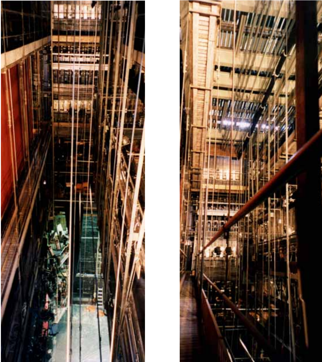
Abbildung 51 Die Beleuchterbrücken und dazwischen das Gewirr der Prospektenzüge
