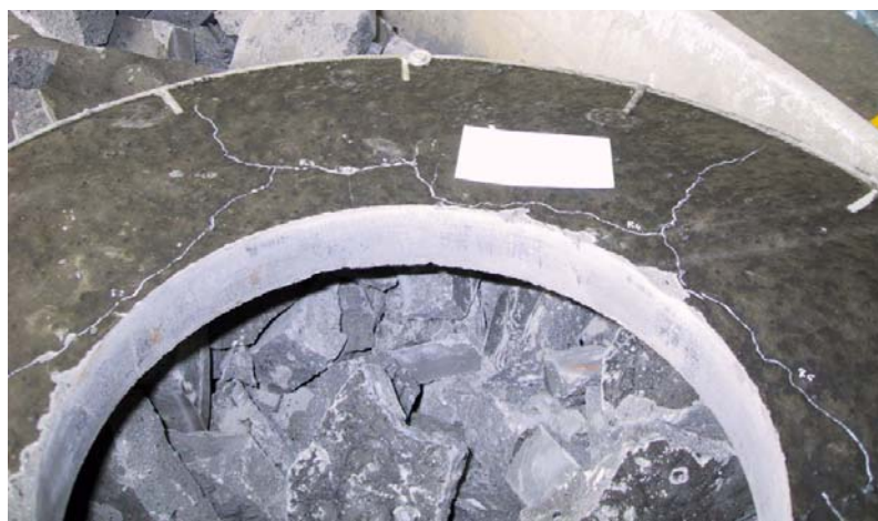
Abbildung 87: Tangentialrisse führen zum Verkleben des Innenrings
