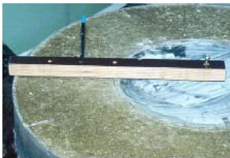
Abbildung 59: Messkreise S1 und S2 an denen die Rissbreiten bestimmt werden; [22]
