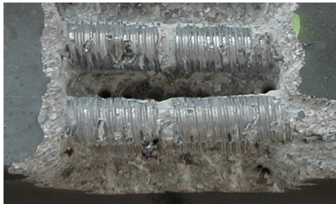
Bild 4.2 Hüllrohre 1 und 4 bei Fuge 10, Seite Wien
