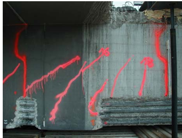
Bild 5.13 Rissbild der Segmente 7 und 8, Seite Graz, nach dem 3. Versuch
