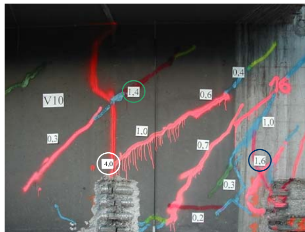
Bild 5.14 Rissbild der Segmente 7 und 8, Seite Graz, nach dem 10. Versuch
