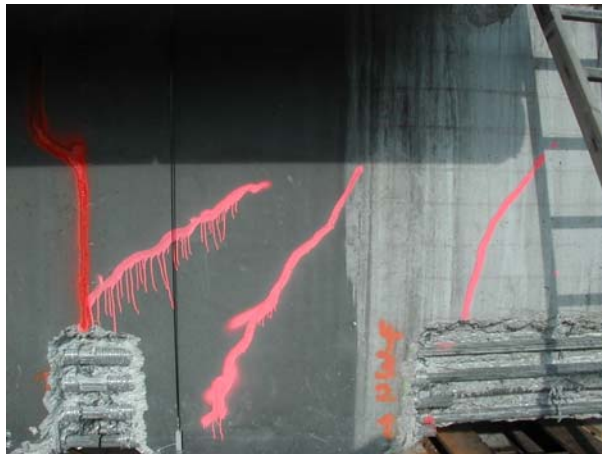
Bild 5.11 Rissbild der Segmente 7 und 8, Seite Graz, nach dem 2. Versuch
