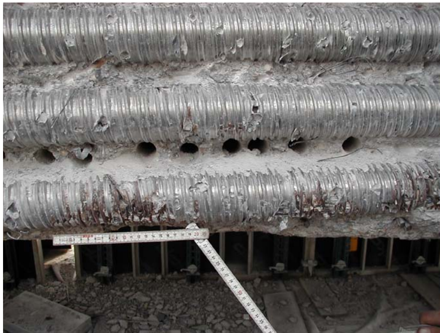
Bild 4.1 Hüllrohre 1, 4 und 7 bei Fuge 9, Seite Wien
