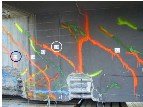
Bild 5.17 Rissbild der Segmente 7 und 8, Seite Wien, nach dem 9. Versuch
