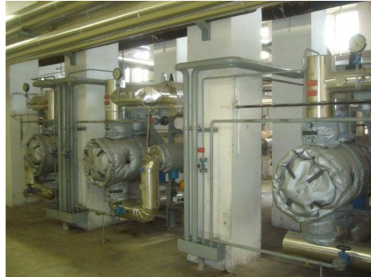
Abbildung 3-29: Die drei Umformerstationen
