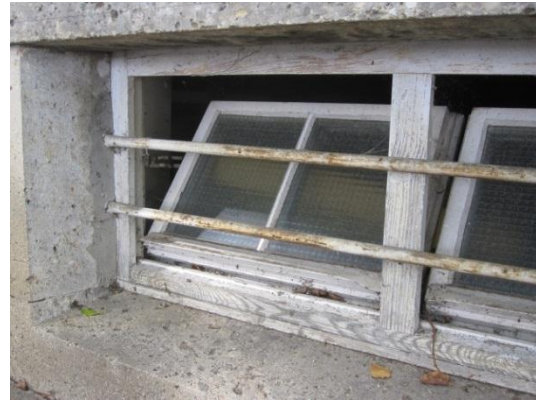
Abbildung 3-19: Detailaufnahme eines typischen Holzkellerfenster FE01 mit Drahtglas
