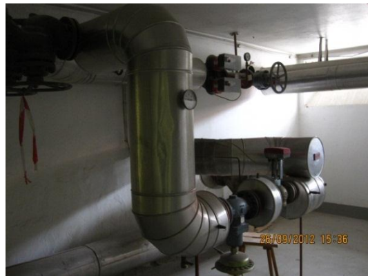
Abbildung 3-31: Rohrleitungssystem des Heizraumes für Fernwärme inklusive Regulierungssystem und Bypassleitung für den Rücklauf
