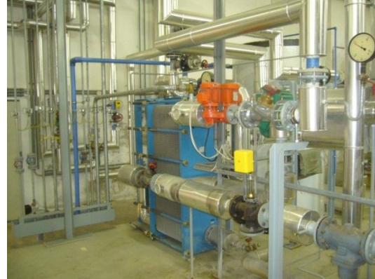
Abbildung 3-36: Wärmetauscher (in blau) für die Warmwasseraufbereitung
