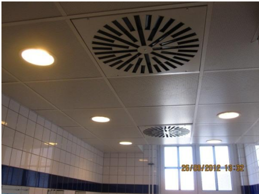
Abbildung 3-38: Neue Lüftungsanlagen im Sanitärbereich - Abzugsventilatoren
