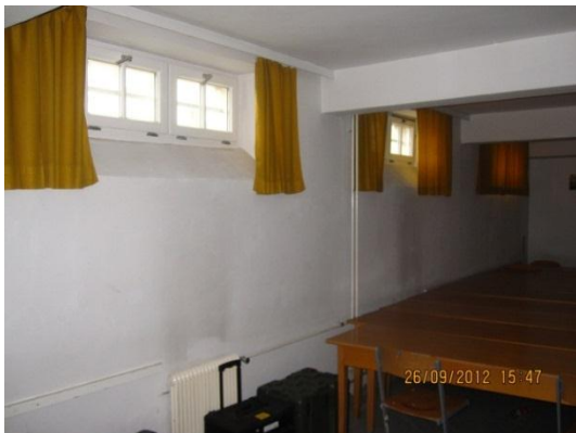
Abbildung 3-20: Teilweise neue Kunststoffkellerfenster FE01-B im Lehrsaalbereich im Untergeschoss
