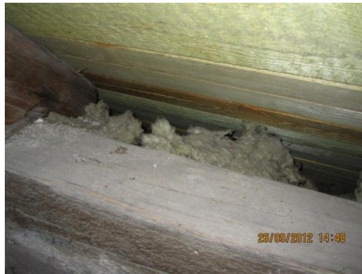
Abbildung 3-13: Ungenügende Dämmung an der Stahlbetonoberseite im Übergangsbereich der Dachschräge – Sargdeckelkonstruktion (Bereich des Drepfels)
