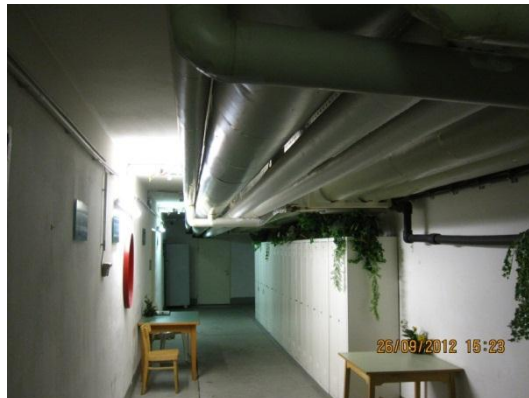
Abbildung 3-33: Heizungs- und Warmwasserversorgungsleitungen im Gangbereich des Untergeschosses an der Kellerdecke
