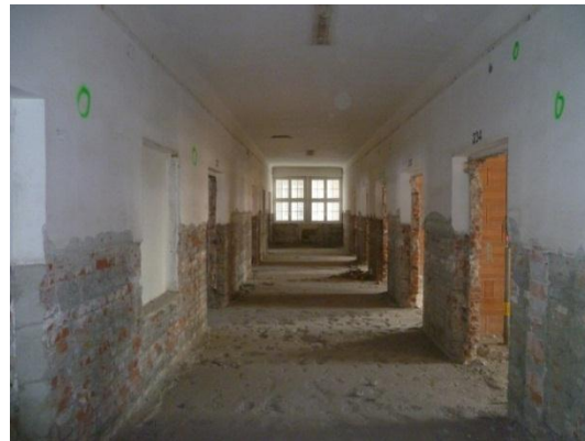
Abbildung 3-5: Vergleich des Gangbereichs zum ausgebauten Zustand – Vollziegelmauerwerk der Baustelle im Block B [22]
