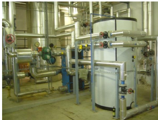
Abbildung 3-37: Warmwasserspeicher (weißer Behälter) - Nenninhalt ca. 1500 Liter
