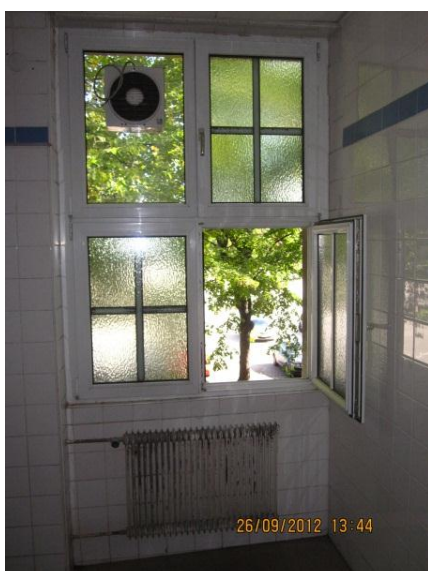
Abbildung 3-40: Alter Sanitärbereich mit defektem Fensterlüfter sowie Radiator
