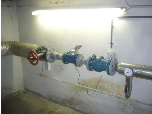
Abbildung 3-35: Ablesestelle mit Absperrventil der Warmwasserhauptzuleitung
