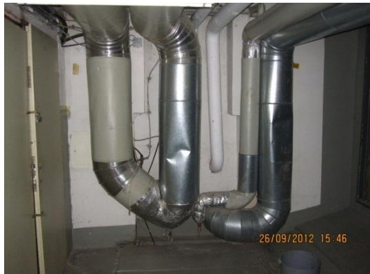
Abbildung 3-32: Heizungs- und Warmwasserleitungen im Gangbereich des Untergeschosses - Verziehungsbereich und Durchbruch zu Block C
