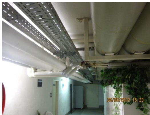
Abbildung 3-3: Heizungs- und Warmwasserleitungen im Gangbereich des Kellers
