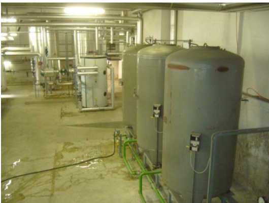
Abbildung 3-30: Drei Ausdehnungsgefäße für das Heizungssystem
