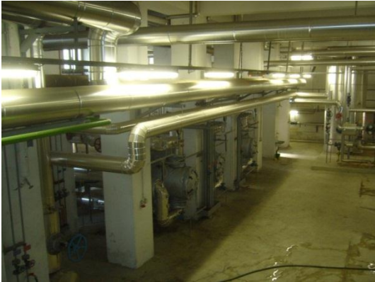
Abbildung 3-28: Fernwärmestation der Maria-Theresien-Kaserne im Objekt 2 – links im Bild die drei Umformerstationen
