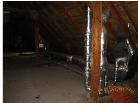
Abbildung 3-39: Haustechnikabluft und Ansaugleitungen für den Sanitärbereich
