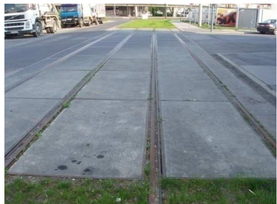
Abbildung 1-17: Rillenschiene in Sebaldgasse [23]
