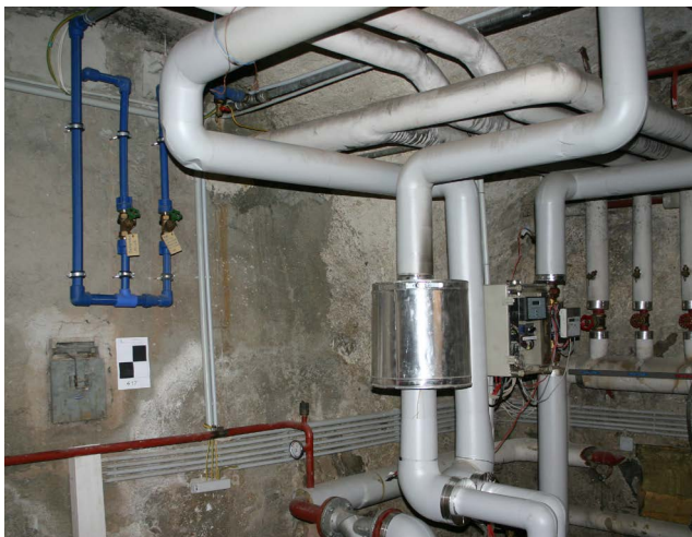
Abb. 23.: Technikraum im Kellergeschoss
