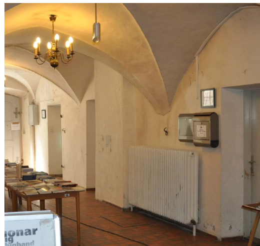
Abb. 24.: Heizkörper im Eingangsbereich
