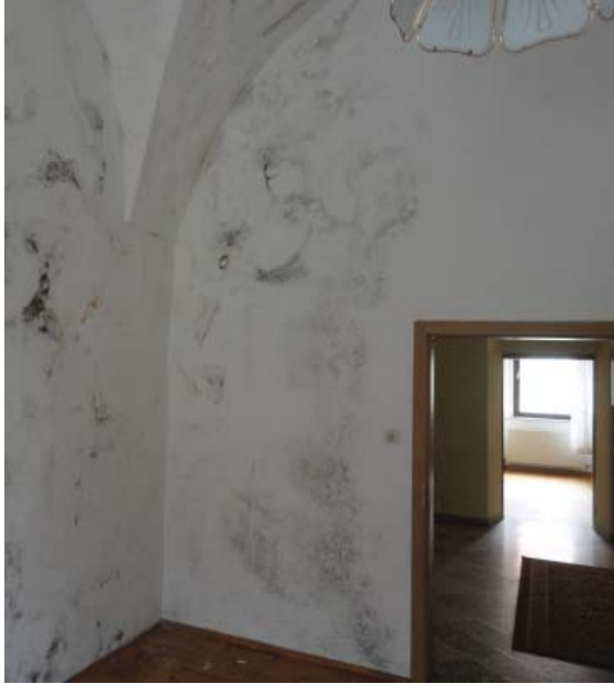
Abb_154: Feuchteschäden der Westwand des Ganges
