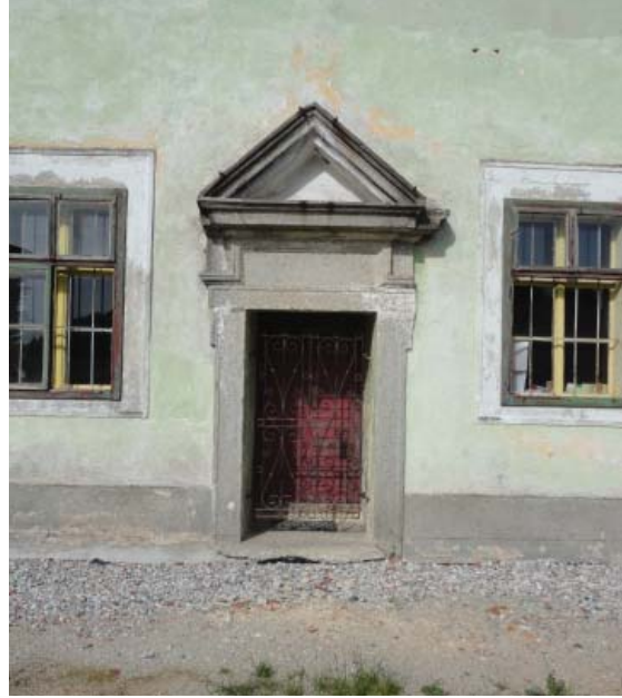
Abb_177: Ostseitiges Portal mit Fehlstellen im Giebel
