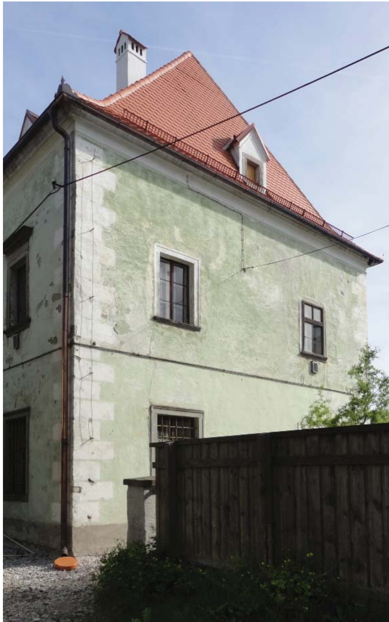
Abb_173: Südfassade mit Putzunebenheiten rund um OG-Fenster und auffälliger halbkreisförmiger Putzstruktur in erster Fensterachse
