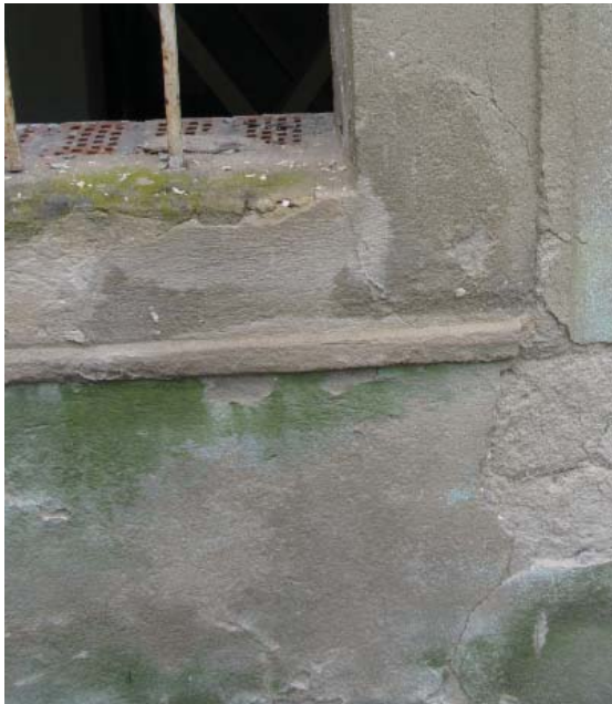
Abb_179: Putzfasche im EG der Hoffassade
