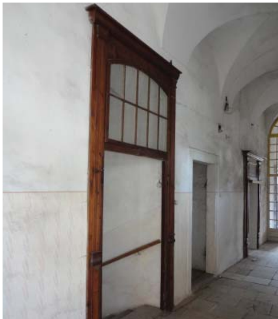
Abb_189: Austritt im Obergeschoss
