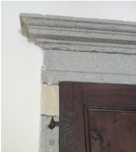
Abb_112: Erkennbare Einfügung unterhalb des Sturzes
