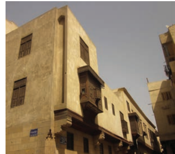
Abb. 27: Außenfassade eines Hofhauses in Kairo mit vergitterten Fenstern und Erkern, die eine Querlüftung ermöglichen.
