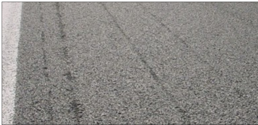
Abbildung 5.25: Beispiel für mechanische Schäden an offenporigen Asphaltdeckschichten durch Radfelgen [114]
