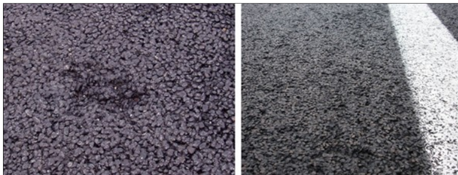
Abbildung 5.24: Beispiele für Kornausbrüche an offenporigen Asphaltdeckschichten
