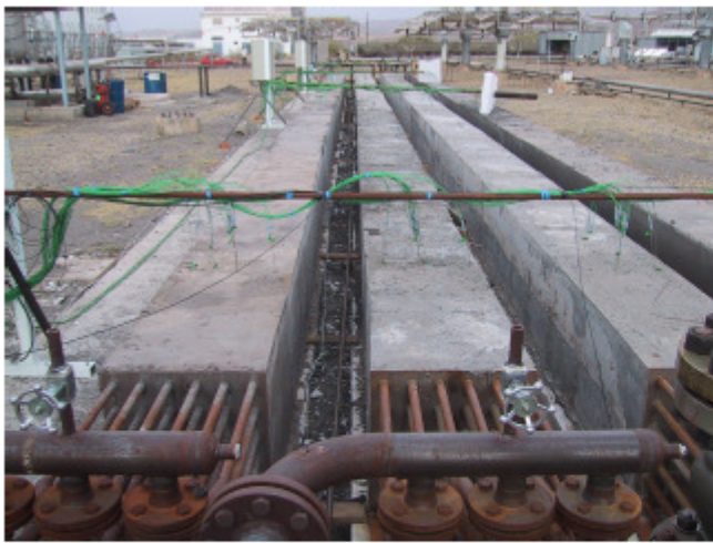
Beton - Feststoffspeicher Testspeicher PSA, Almeria 4 Module zu jeweils 25 kW, 80 kWh Testbetrieb 2004/2005
