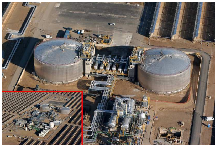
Abbildung 5.1: Flüssigsalz-Kalt- und Warmspeicher des Kraftwerkes Andasol [Rel09]
