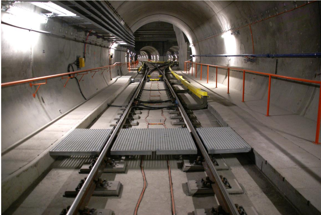
Abbildung E-5: Ansicht des schotterlosen Vignolschienen-Oberbaues (Feste Fahrbahn) in der Wiener U-Bahn mit Bi-Blockschwellen in Gummischuhen in elastisch gelagerter Gleistragplatte im Tunnel
