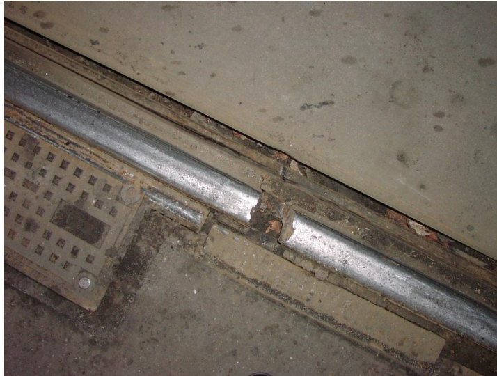
Abbildung D-8: Bruch einer Rillenschiene mit Fahrkopfausbruch im Bereich einer Weichenzunge
