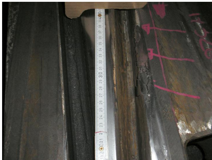
Abbildung D-31: Durch hohl gelaufene Räder beschädigtes Gussherz
