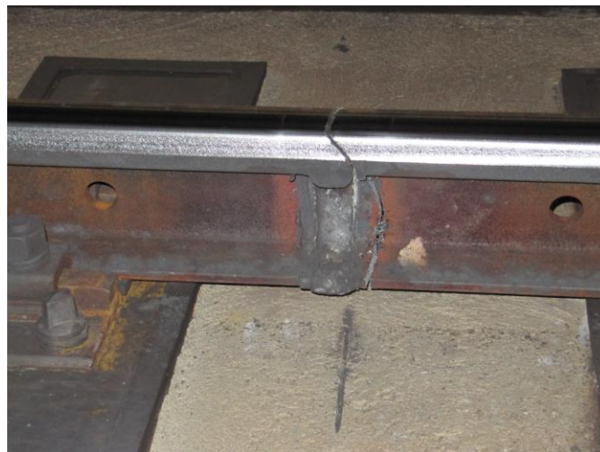
Abbildung D-24: Bruch einer Vignolschiene bei einem aluminothermischen Schweißstoß
