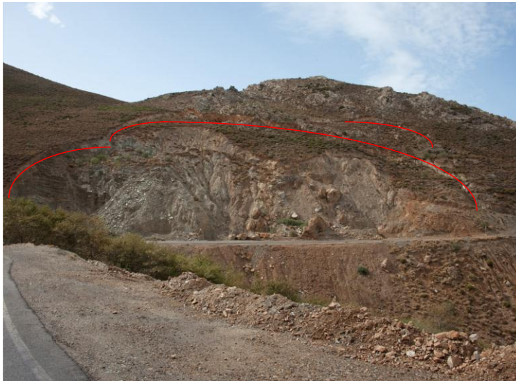
Abbildung D-35: Hangrutschung mit potentiellen Abbruchkanten (rote Linien)
