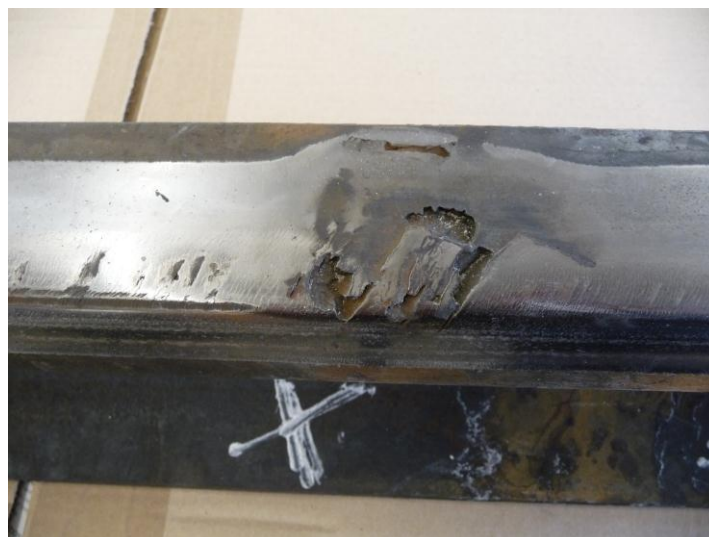
Abbildung 1-6: Korrosion auf der Schienenoberfläche durch eindringendes Wasser von der Tunneldecke
