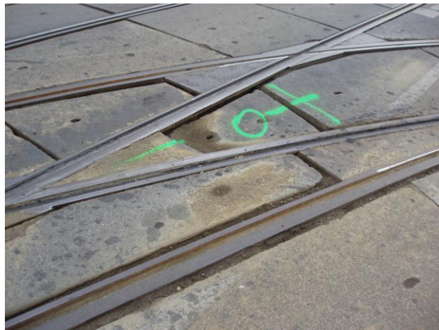
Abbildung D-18: Eingebrochene Stahlbetongroßflächenplatten (infolge Unterwaschung)
