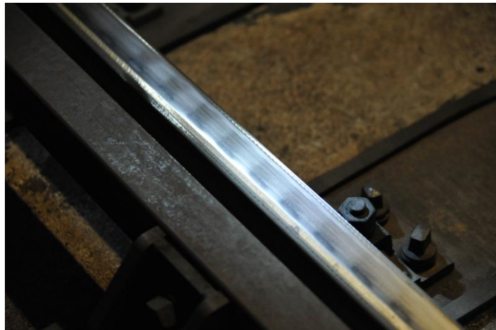
Abbildung D-29: Schlupfwellen auf einer Innenschiene im Gleisbogen
