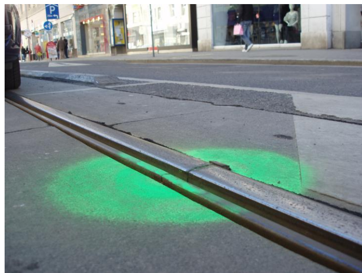
Abbildung D-10: Bruch einer eingebetteten Rillenschiene
