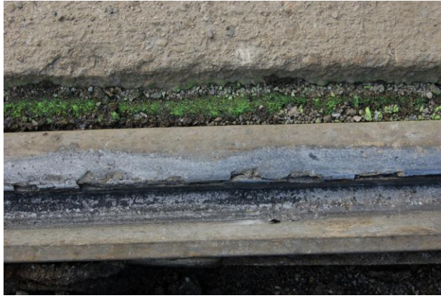
Abbildung D-14: Ausgebrochene Fahrkante einer eingebetteten Rillenschiene
