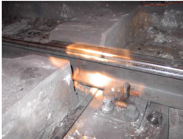
Abbildung D-26: Schienenbruch (Ermüdung) zufolge fehlerhafter Lagerungsbedingung (Aufsitzen der Schiene auf einem Betonriegel für Hochwasserschutzdammbalken und damit Kerbbildung am Schienenfuß)
