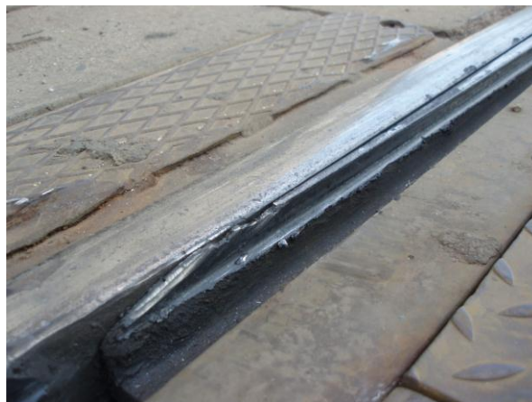
Abbildung D-16: Ausgebrochene und abgebrochene Zungenspitze einer Rillenschienenweiche (nicht mehr befahrbar)
