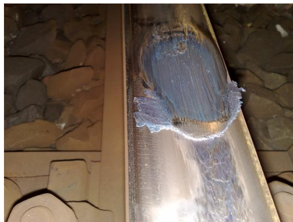
Abbildung D-21: Brandloch (Schleuderstelle) infolge eines durchdrehenden Rades in einer Vignolschiene
