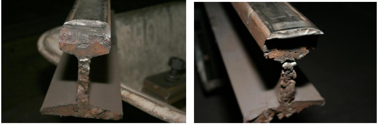
Abbildung D-25: Schienenbruch zufolge mangelhafter E-Handschiweißung
