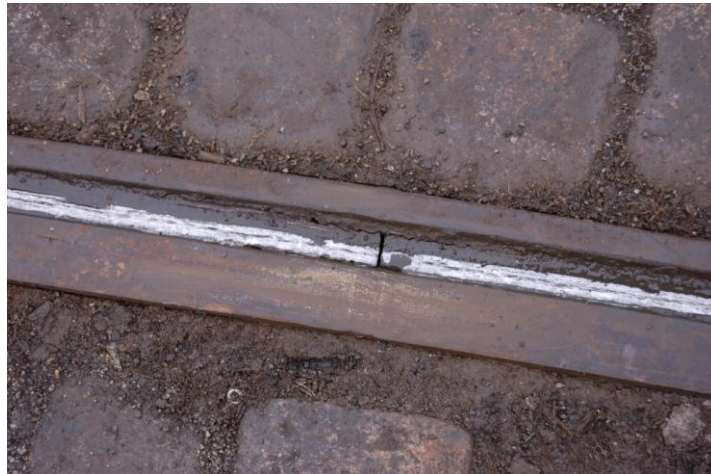
Abbildung D-9: Bruch einer Grundierung in einer Rillenschiene
