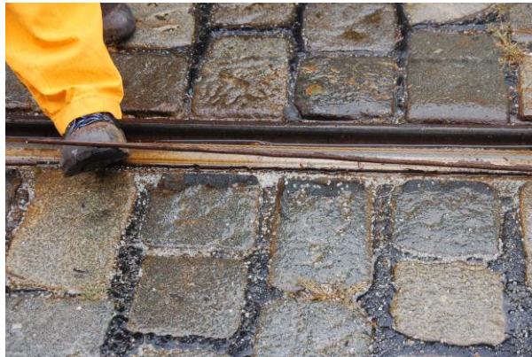
Abbildung D-15: Abgebrochen Schienenüberwalzung (Schienengrat) an einer Rillenschiene
