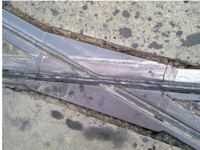
Abbildung D-11: Bruch einer eingebetteten Rillenschiene beim Herzstück
