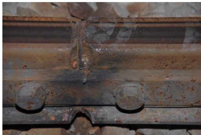
Abbildung D-23: Kurzgeschlossener und ausgeronnener Isolierstoß
