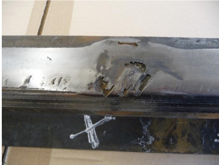
Abbildung D-28: Korrosion durch Wassertropfen auf der Schienenoberfläche
