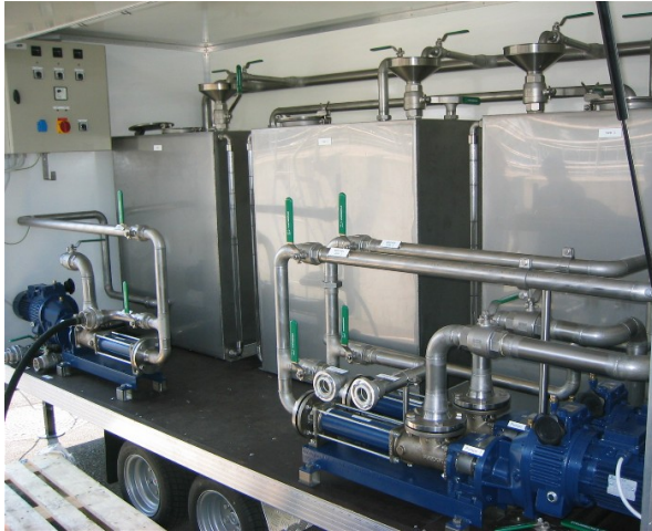
Abbildung 17-3: Vorlagebehälter für Reinigungsflüssigkeit
