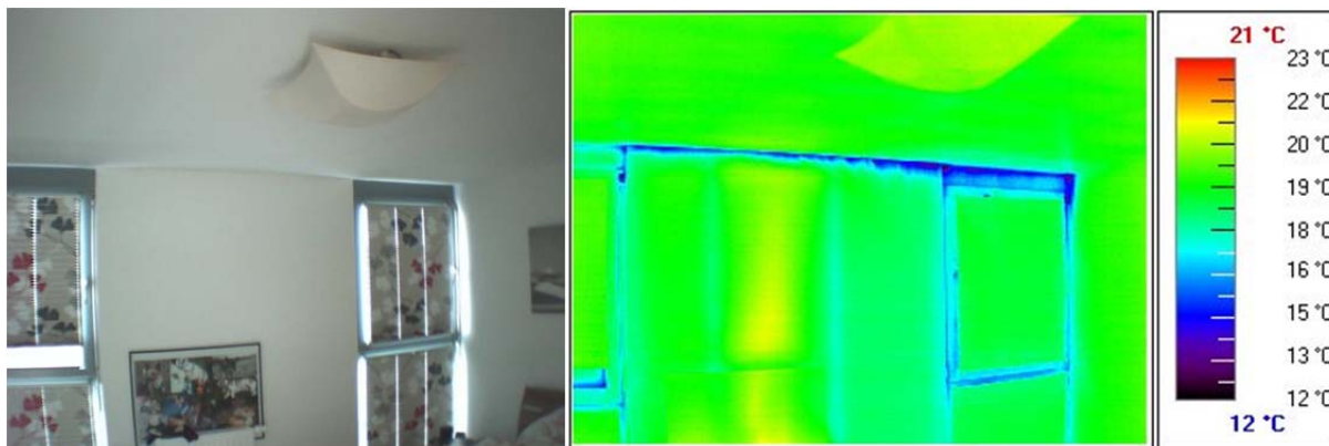
Abb. 27 : Normalbild (links), Thermobild (rechts): Leckage am Wand/Fenster – Deckenstoß im Obergeschoss
