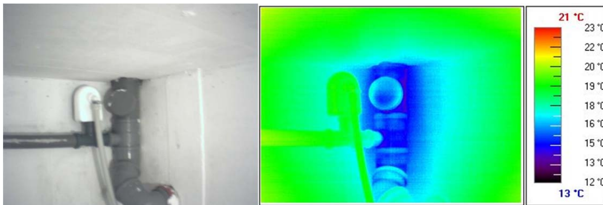
Abb. 21 : Normalbild (links), Thermobild (rechts): Leckage am Abflussrohr im Keller
