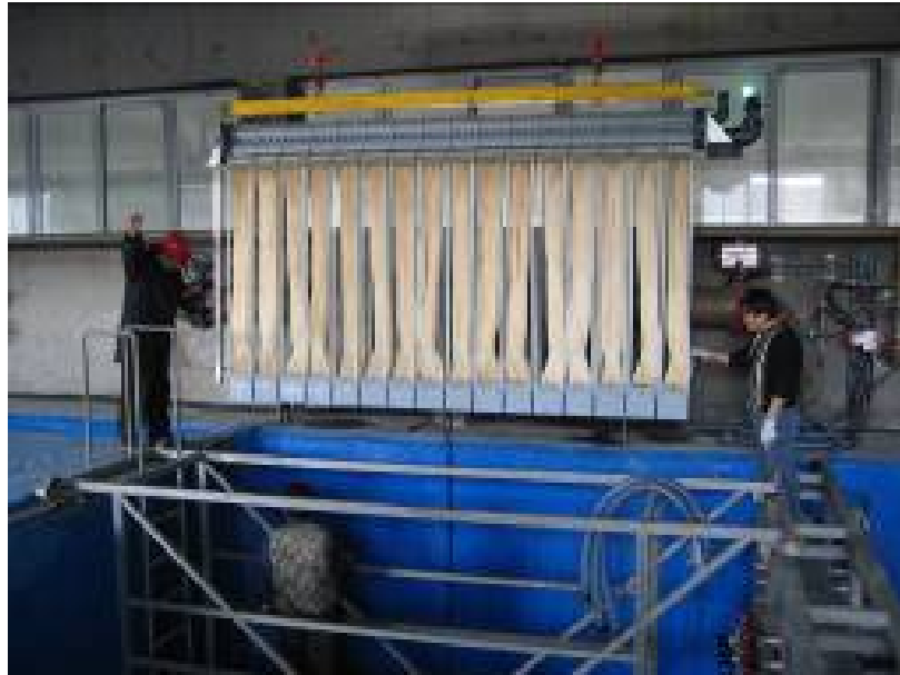
Abbildung 4: BXH-WRP 1 – MBR (Einbau eines Memcor Memjet Moduls)
