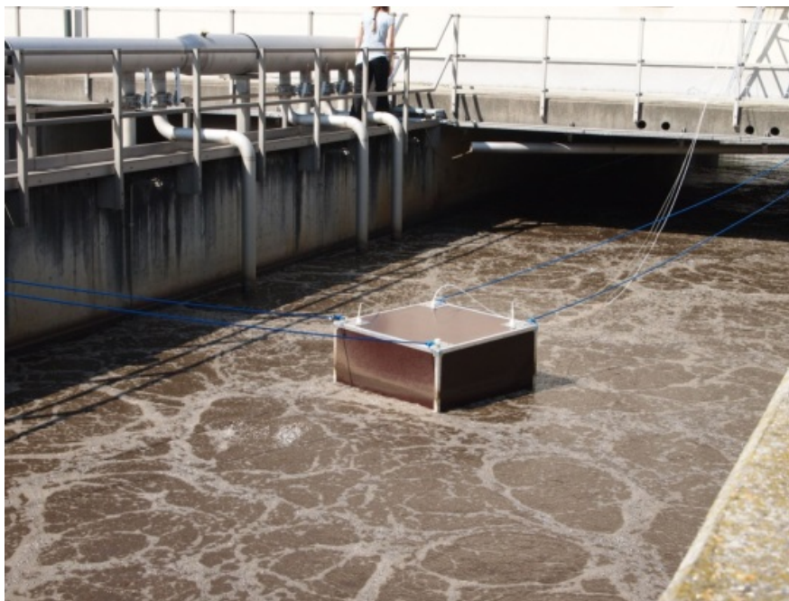
Abbildung 5: Messung des \text{N}_2\text{O} -Gealtes in der Abluft aus einem Belebungsbecken mittels Ablufthaube.
