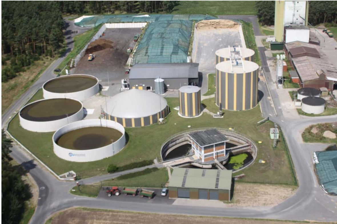
Abbildung 7: Biogasanlage des Abwasserverbandes
