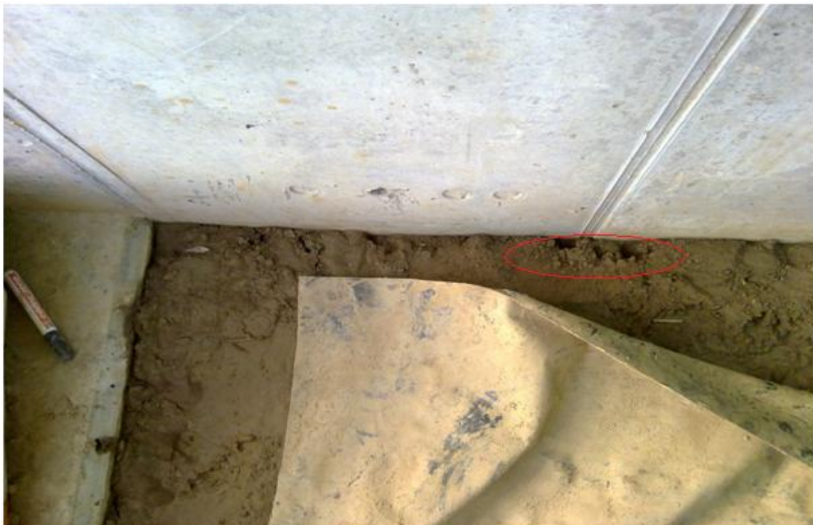
Abbildung 3.29 Leckbildung im Hinterland des Dammes aufgrund von Fugenerosion entlang des Schalungsstoßes
