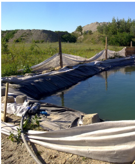
Abbildung 3.6 Tauchpumpe und Vorhaltebecken
