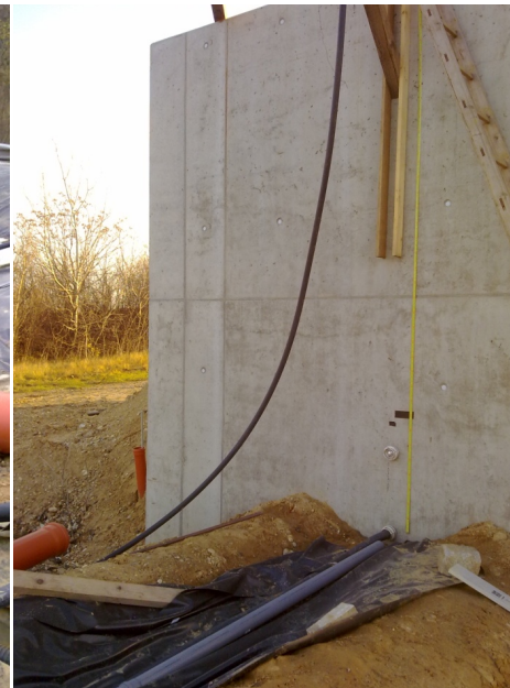
Abbildung 3.9 Rückleitung über Anschlüsse in der Rückwand des Stahlbetontroges
