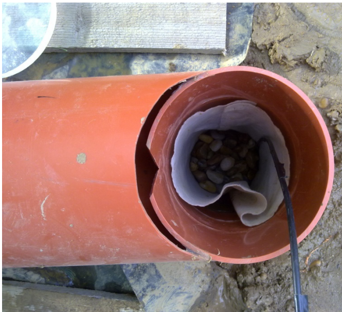
Abbildung 3.31 oben: Messwehrrohr auf Kiessäule und eingebauten Messpegel, links im Bild: Abflussrohr für die Wiedereinleitung des Versuchswassers
