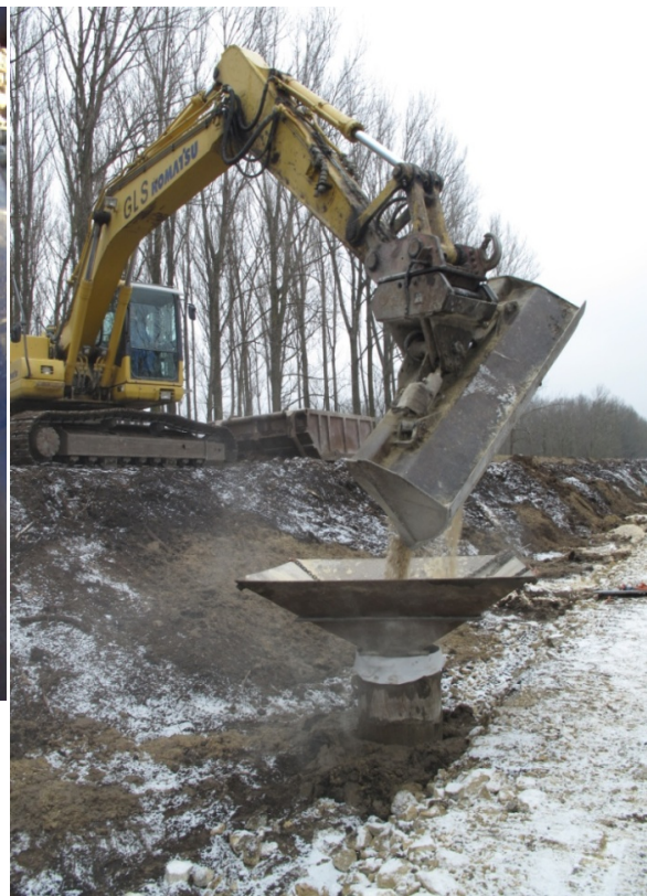
Abbildung 2.11 (rechts): Herstellung einer Kiessäule: Beschickung mit Bagger, eingeklemmtes Filtervlies zwischen Trichter und Ziehrohr [12].
