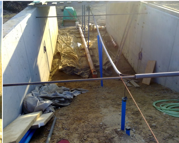
Abbildung 3.5 Ableitung der Sickerwässer, Blick in Richtung Rückleitung in das Vorhaltebecken
