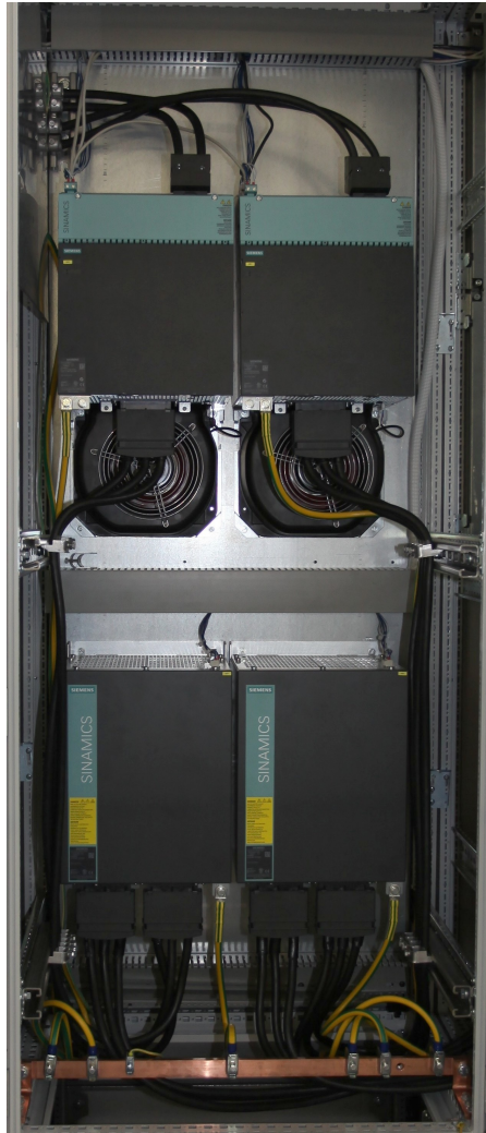
Abbildung 3.5.: Schaltschrank mit den Gleichrichtern
