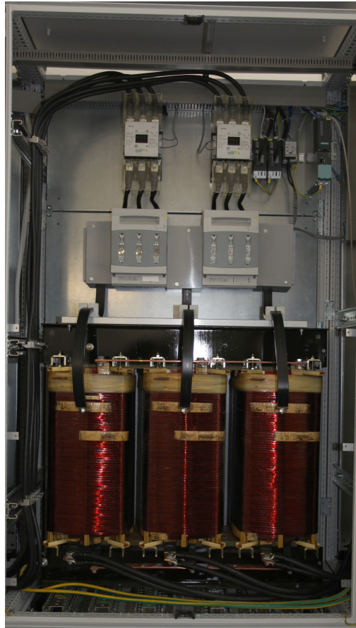
Abbildung 3.7.: Schaltschrank mit dem Trenntransformator
