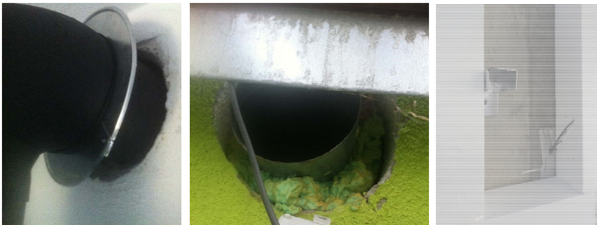
Abbildung 32: Durchdringung der thermischen Gebäudehülle mit Lüftungskanälen (raumseitige Durchdringung - linkes Bild; außenseitige Durchdringung – mittleres Bild) und den metallenen Halterungen einer Verblendung (rechtes Bild)
