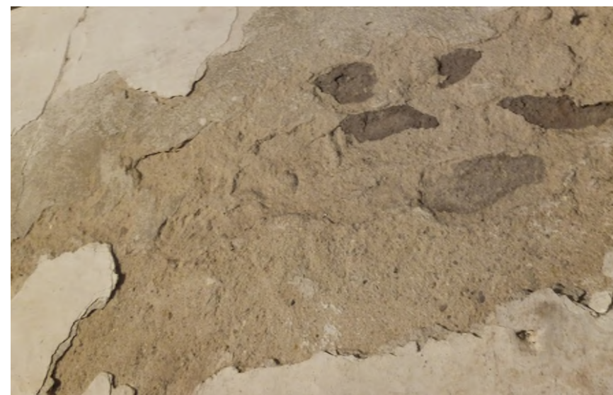
Sanierungsschäden durch Dispersionsanstrich
