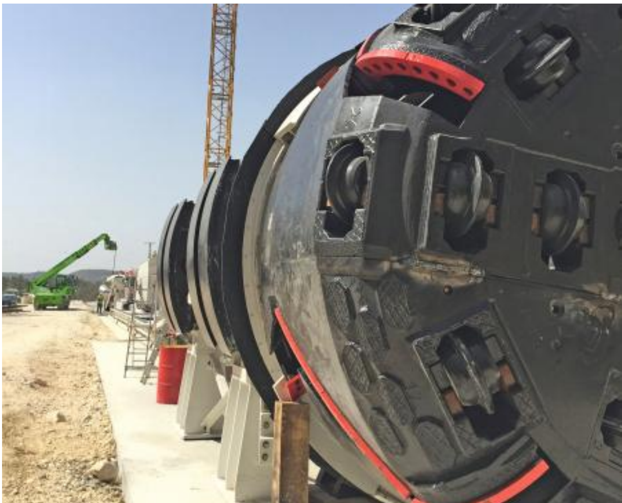
Abb. 5.5: TVM beim Aufbau (Quelle: Fachmagazin - THIS [4])
